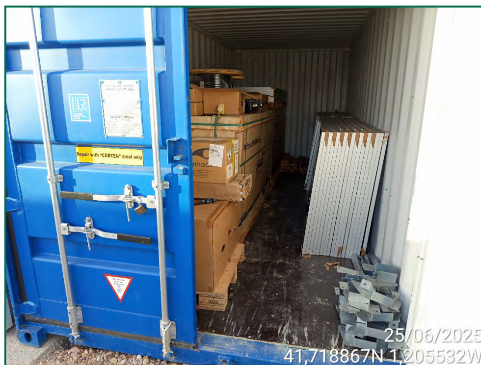
Fotografía 54. Restos de materiales.
