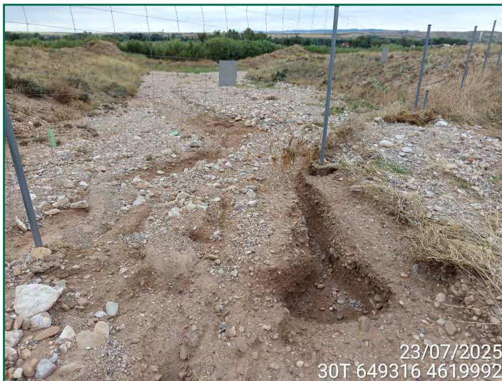
Fotografía 5. Escorrentía y sedimentación fuera y dentro del vallado tras el temporal.
