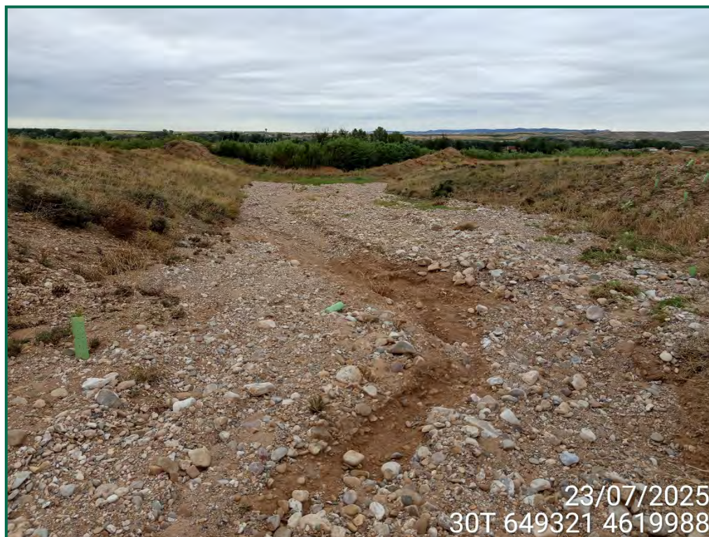
Fotografía 6. Escorrentía y sedimentación fuera del vallado tras el temporal.
