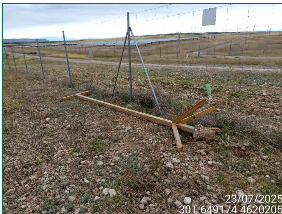
Fotografía 37. Posadero desprendido después del temporal.
