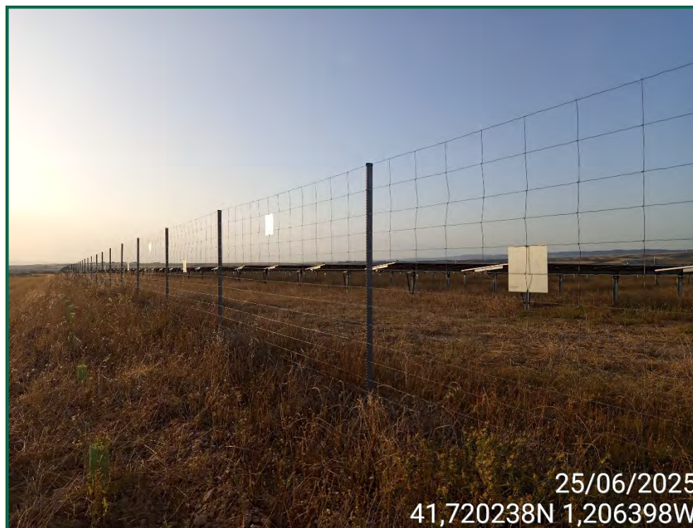
Fotografía 29. Placas anticolidión y vallado perimetral.
