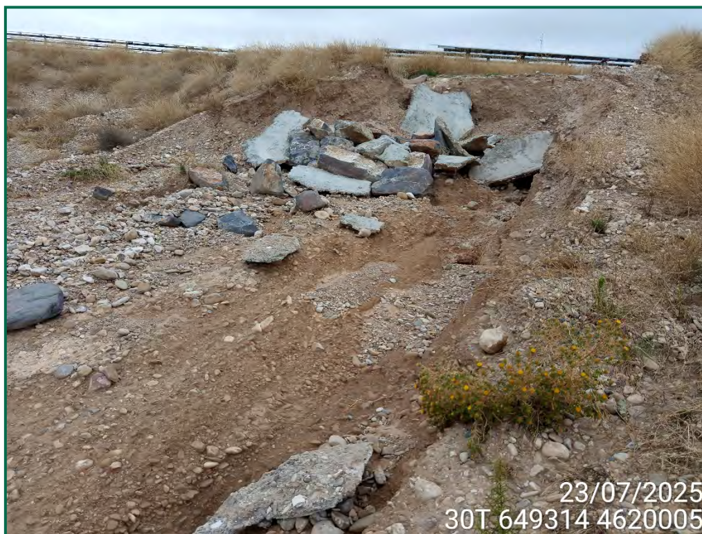
Fotografía 12. Zonas de acumulación de agua por escorrentía después del temporal.
