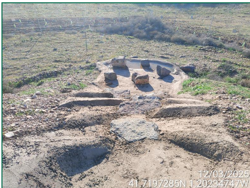
Fotografía 6. Zonas de acumulación de agua por escorrentía.
