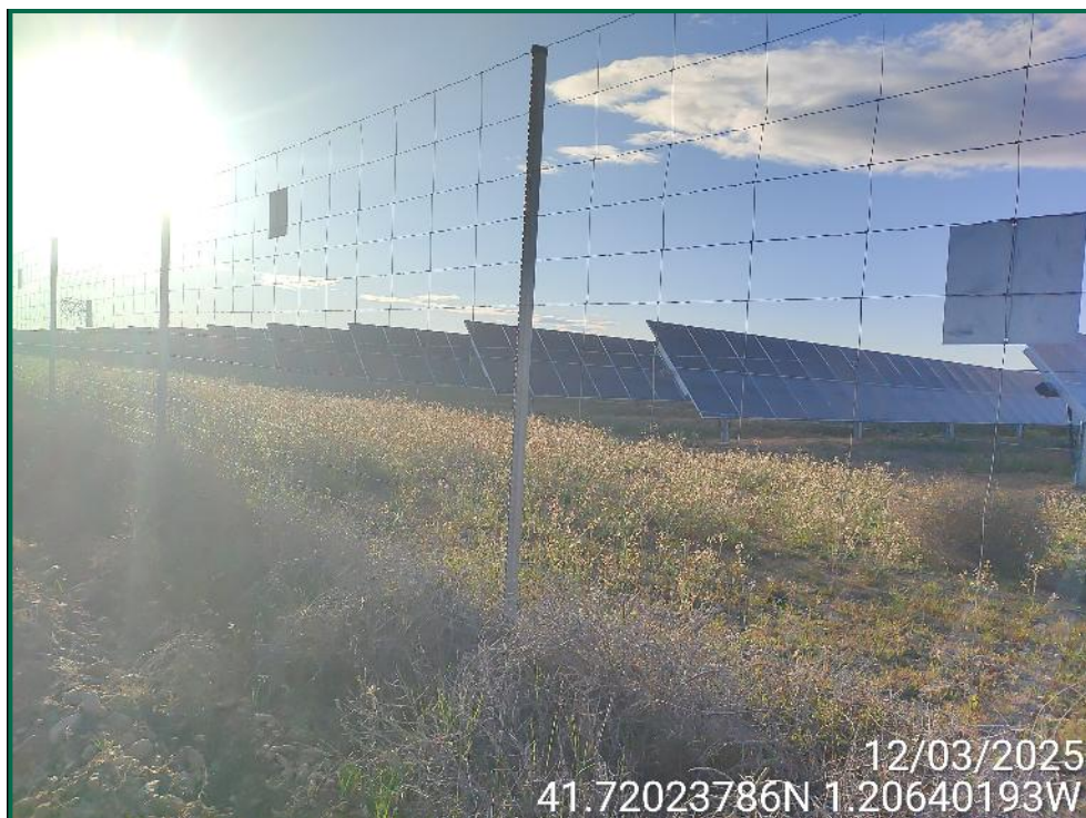
Fotografía 25. Placas anticollisión y vallado perimetral.
