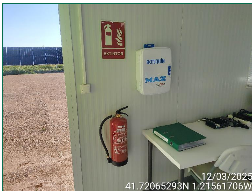
Fotografía 30. Extintor en la caseta de control.
