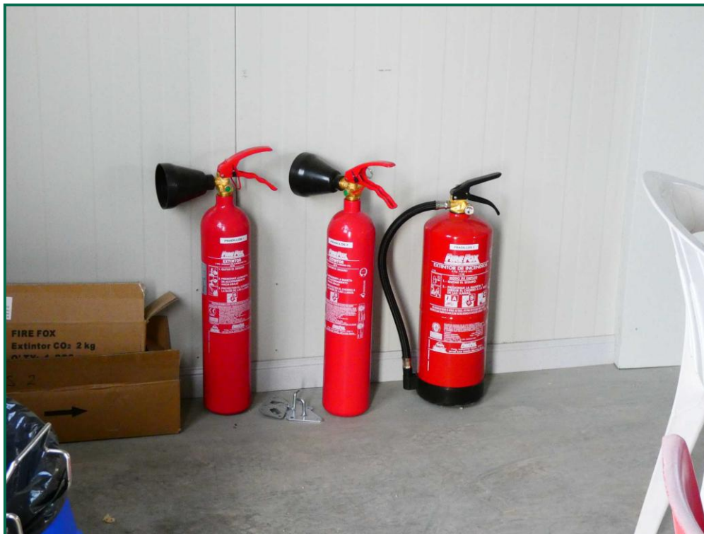
Fotografía 29. Extintores en zona de casetas.
