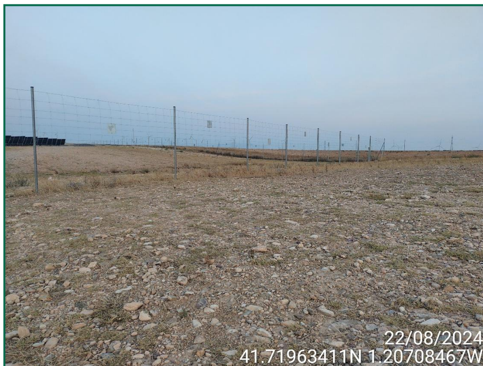
Fotografía 16. Placas anticollisión y vallado perimetral.
