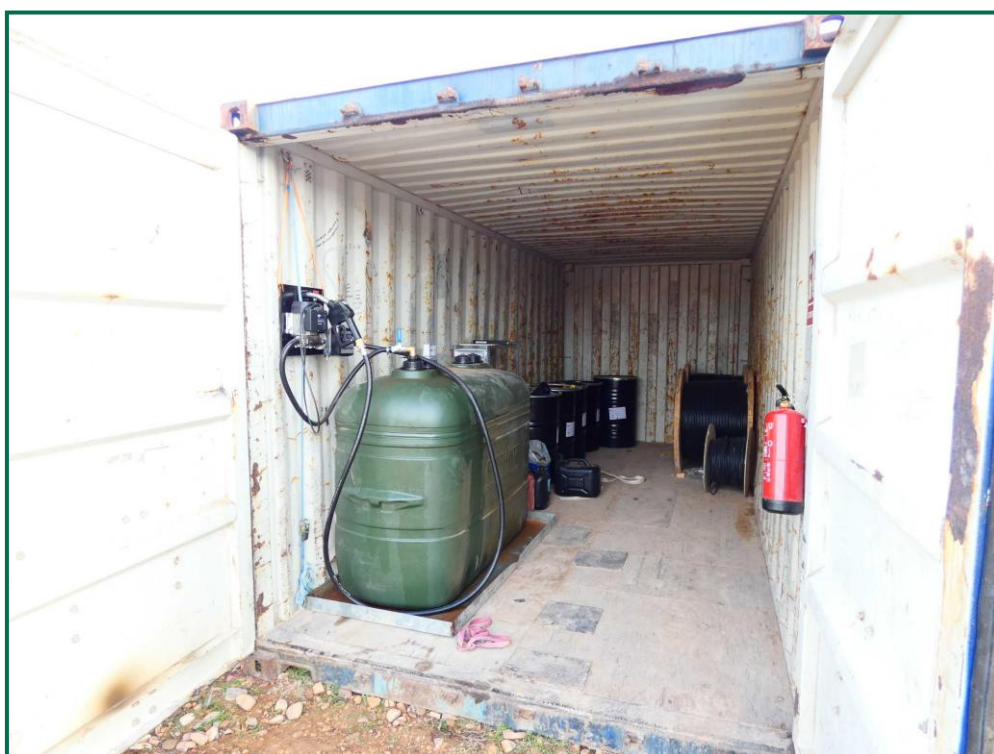
Fotografía 26. Envase de combustible y bandeja de contención.
