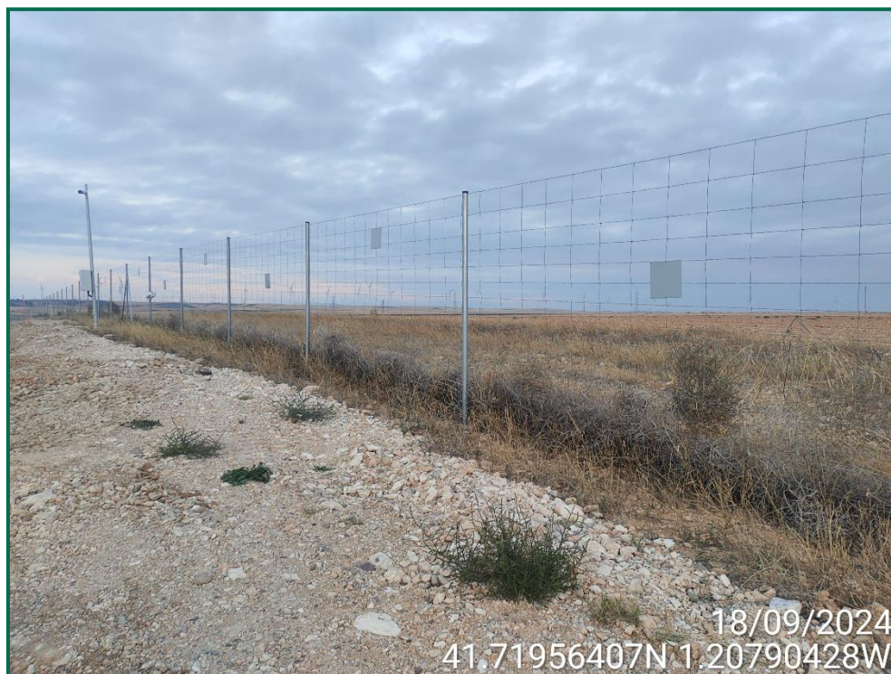
Fotografía 15. Placas anticollisión y vallado perimetral.
