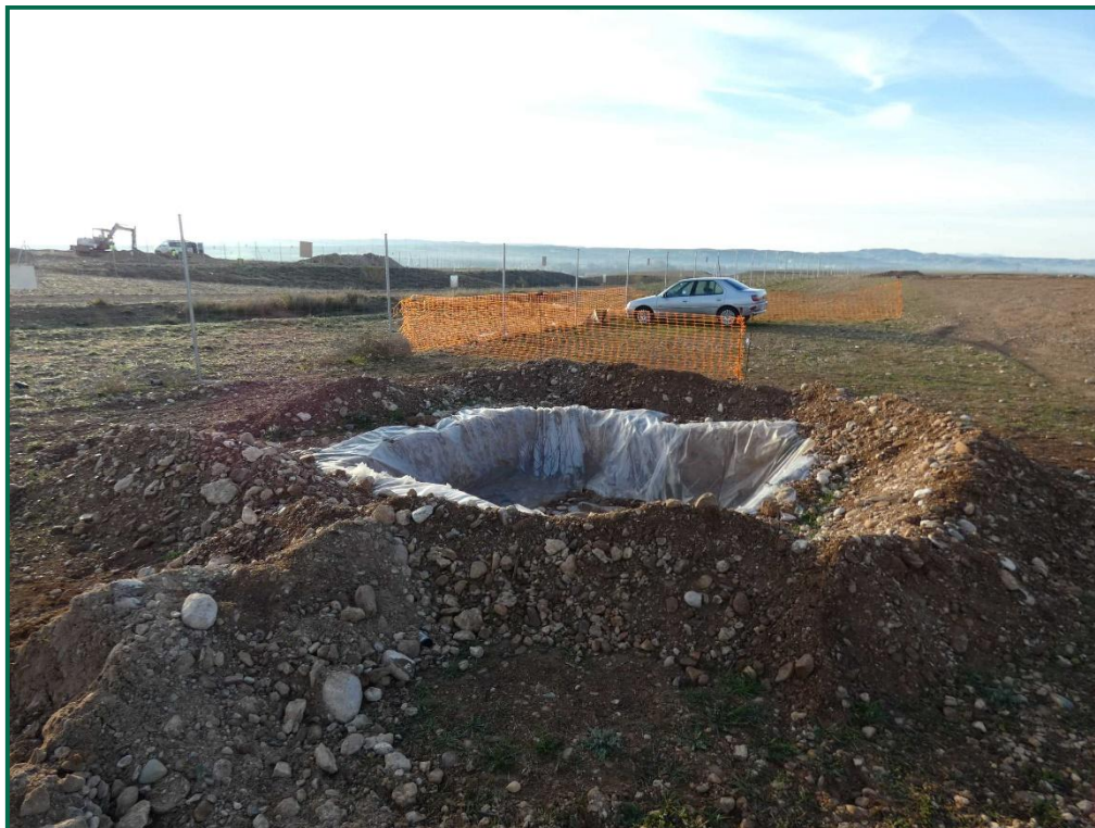
Fotografía 27. Balsa de limpieza.
