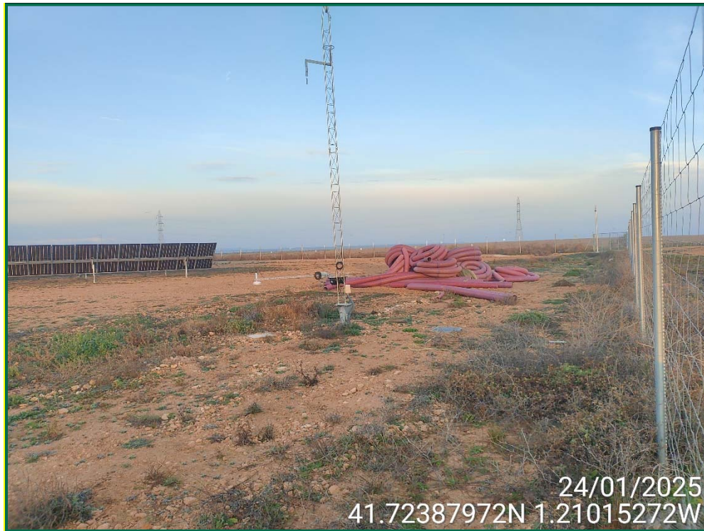
Fotografía 8. Restos de materiales.
