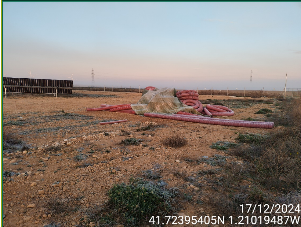
Fotografía 9. Restos de materiales.
