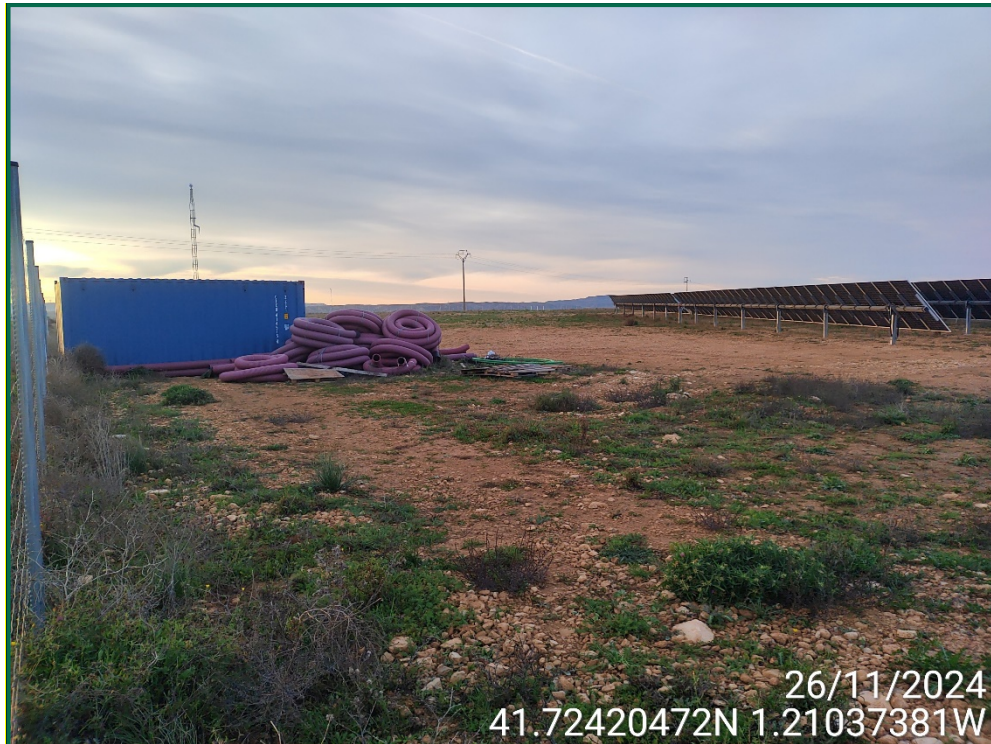
Fotografía 8. Restos de materiales.
