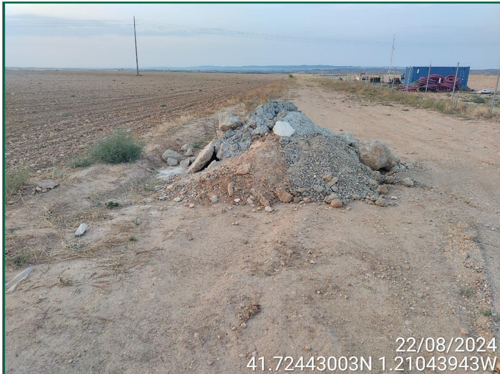
Fotografía 10. Restos de tierra y hormigón.
