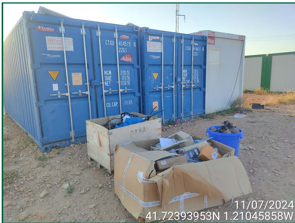
Fotografía 14. Restos de materiales y contenedores de almacenaje.
