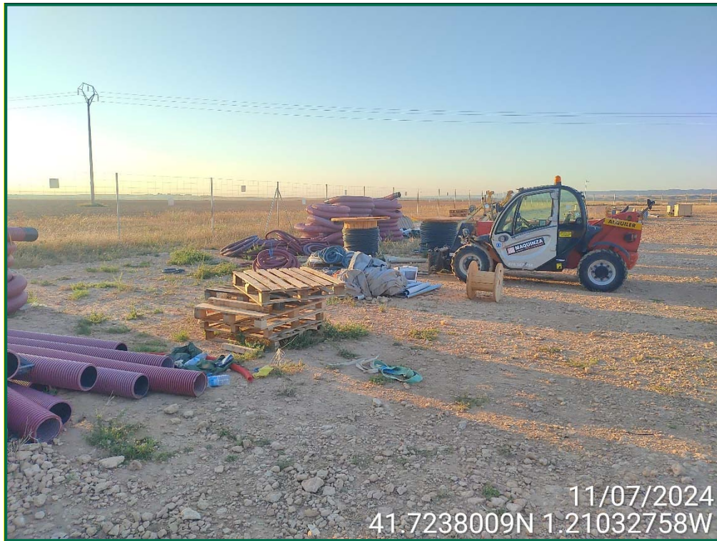
Fotografía 15. Restos de materiales.
