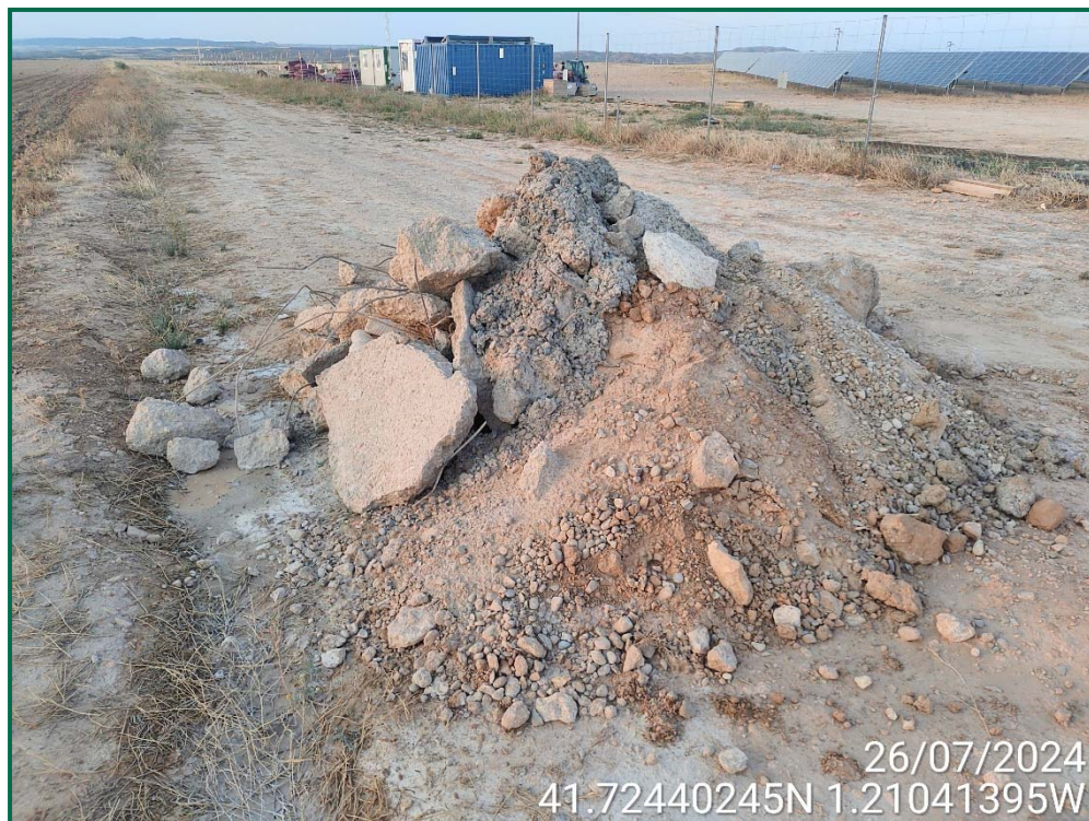
Fotografía 16. Restos de tierra y hormigón.
