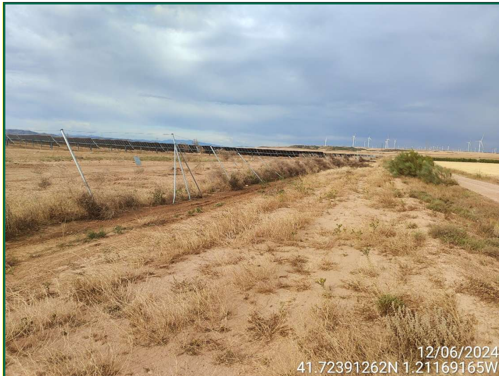
Fotografía 12. Vallado doblado por la acción del viento.
