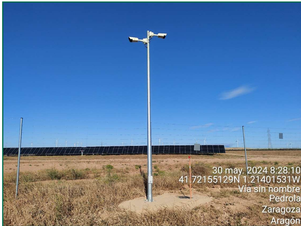
Fotografía 4. Cámara de vigilancia.
