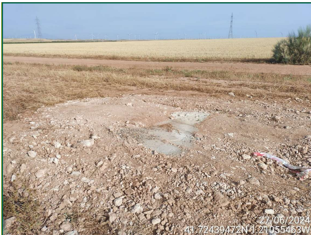
Fotografía 20. Balsa de limpieza tapada tran la colocación del nuevo vallado.
