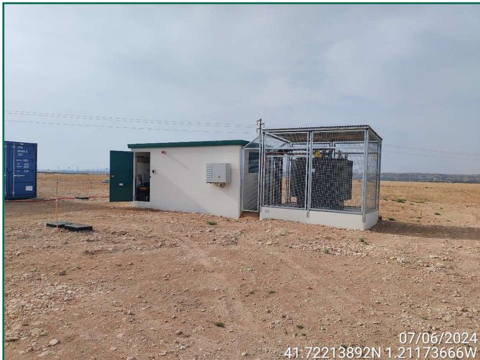
Fotografía 5. Caseta del CT.
