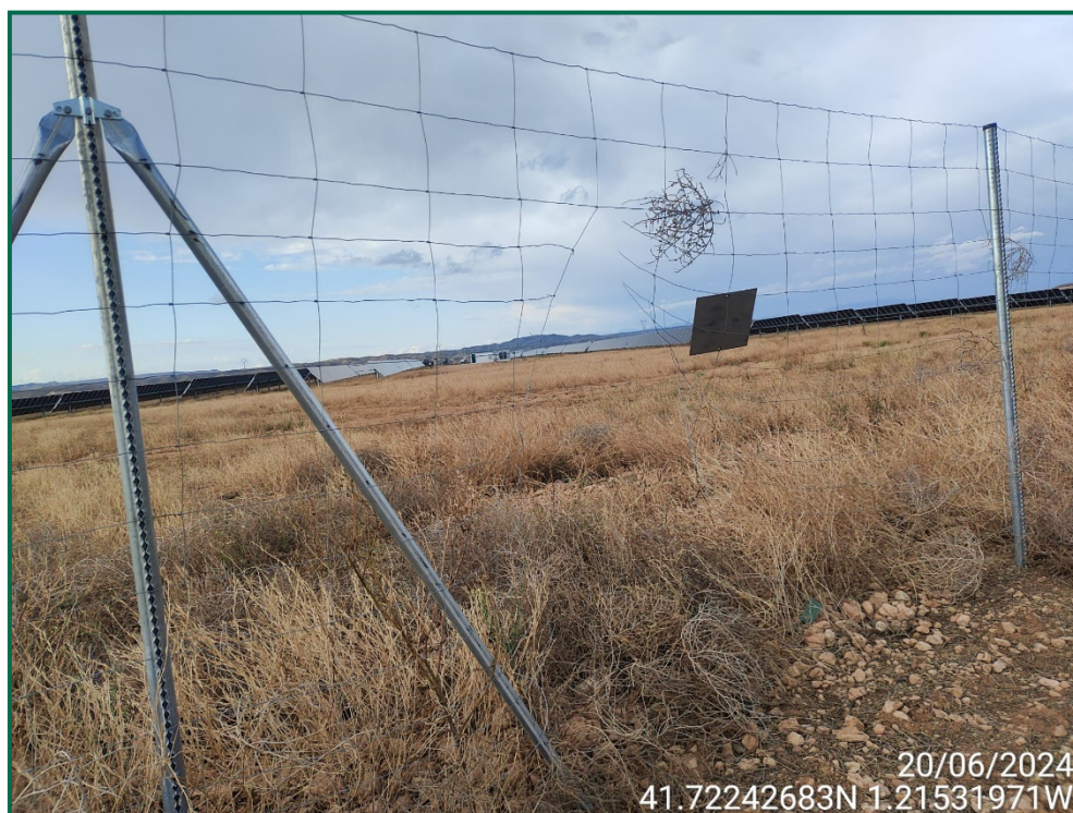
Fotografía 11. Destrozos en el vallado por robo.
