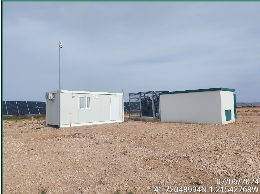
Fotografía 4. Estructura del CT
