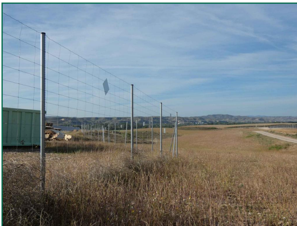
Fotografía 12. Placas anticolidión y vallado perimetral.
