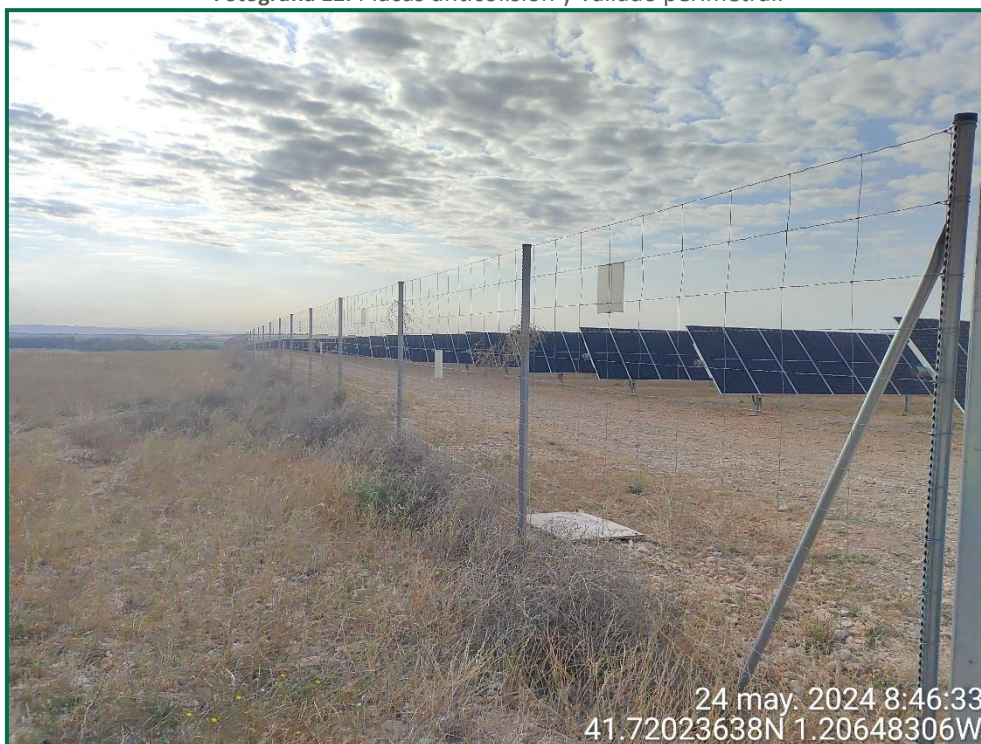
Fotografía 13. Placas anticolidión y vallado perimetral.
