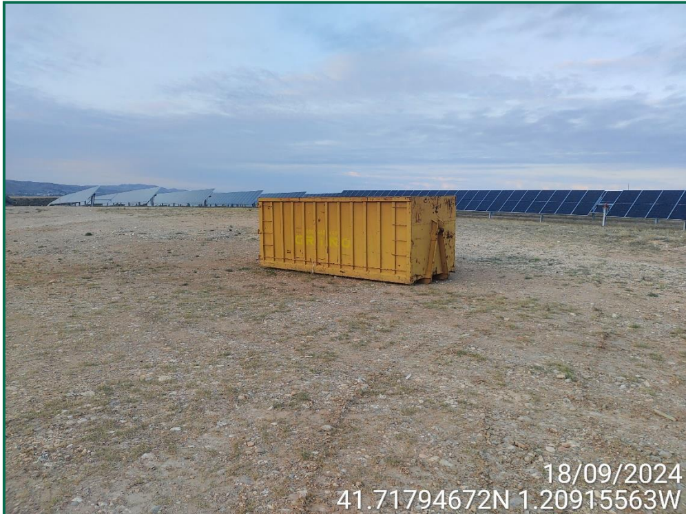
Fotografía 13. Contenedor de residuos sobre la superficie de la obra.
