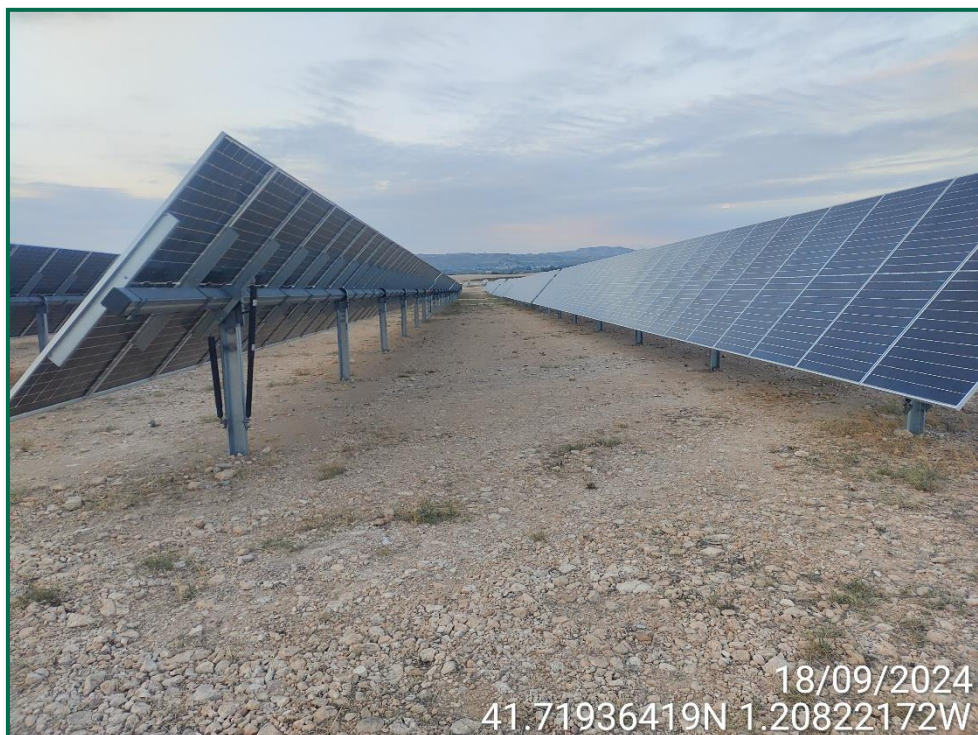
Fotografía 9. Poca cubierta vegetal, se observa erosión.
