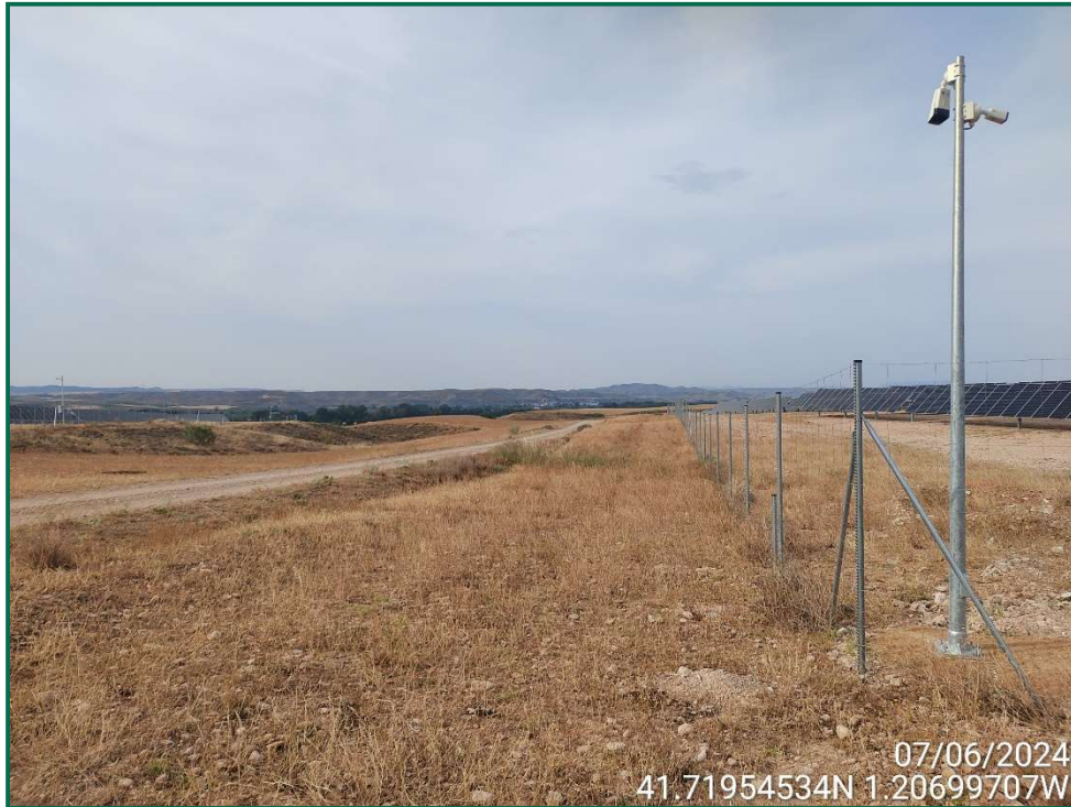
Fotografía 6. Cámaras de vigilancia colocadas.
