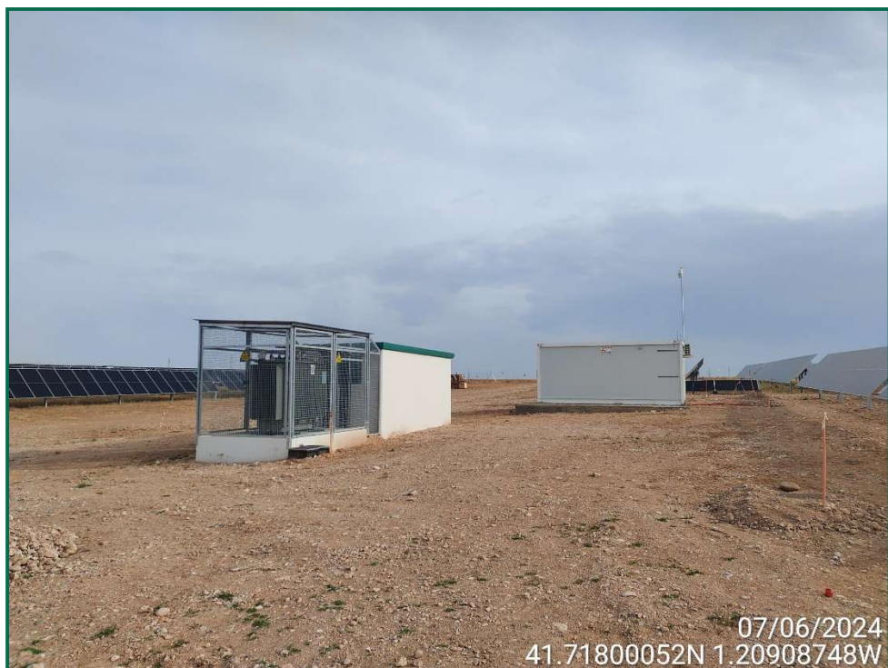
Fotografía 5. Estructura del centro de transformación.
