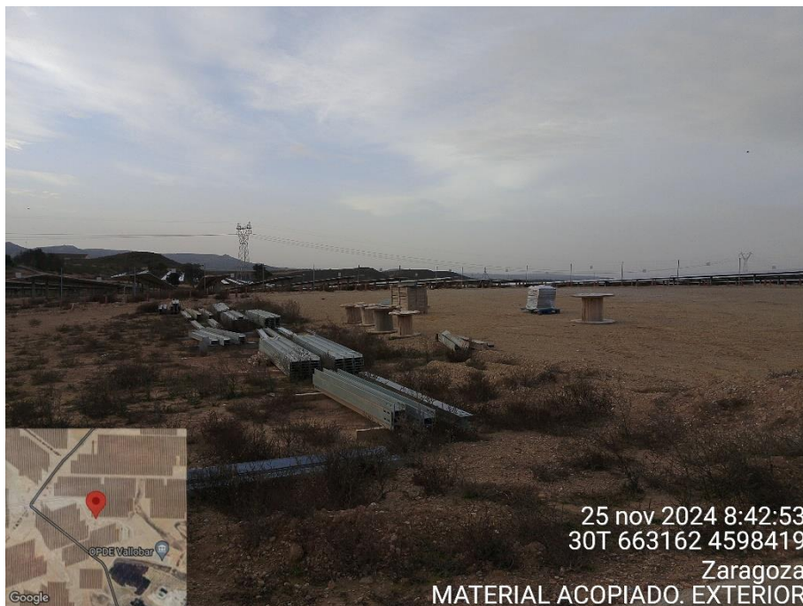
Fotografía 7. Material acopiado en el exterior de la PSFV
