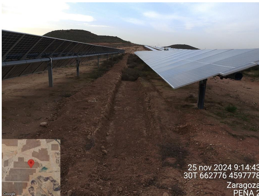
Fotografía 10. Red de drenaje interna de la PSFV
