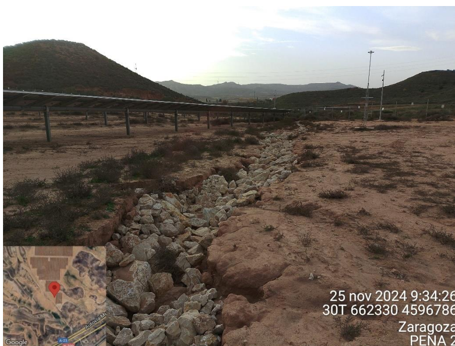
Fotografía 11. Red de drenaje interna de la PSFV
