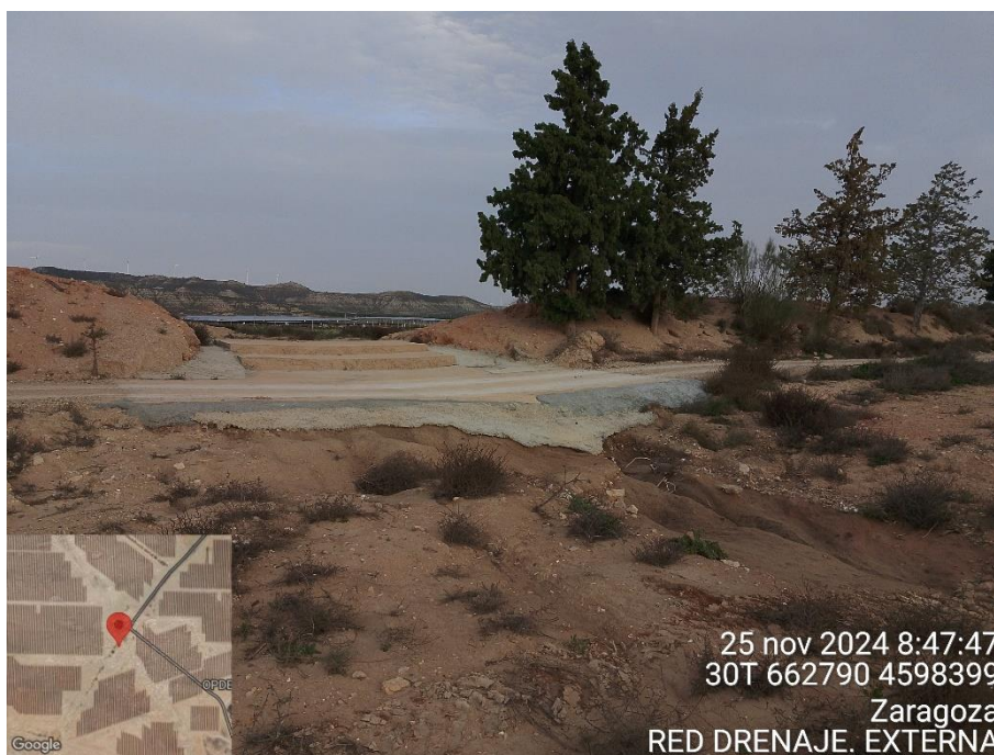
Fotografía 8. Red de drenaje externa de la PSFV
