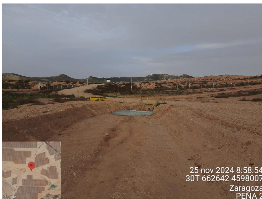
Fotografía 9. Red de drenaje interna de la PSFV
