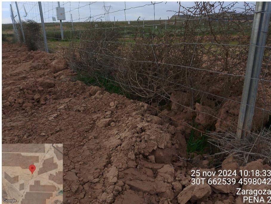
Fotografía 11. Zona del vallado perimetral donde no hay espacio libre desde el suelo
