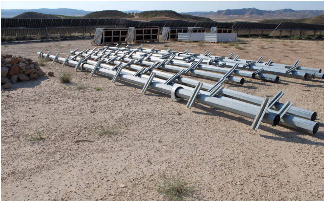
Fotografía 7. Materiales acopiados en PSFV Pena 2 Zona 05
