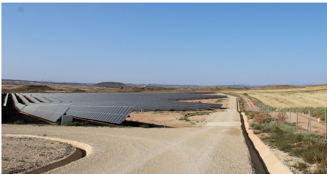
Fotografía 9. Infraestructuras de drenaje en PSFV Pena 2
