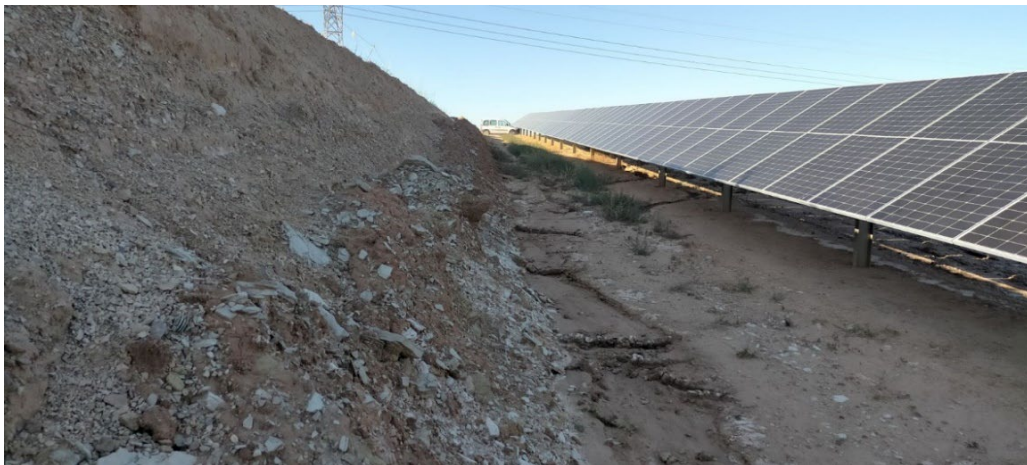
Fotografía 5. Infraestructuras de drenaje en PSFV Pena 2
