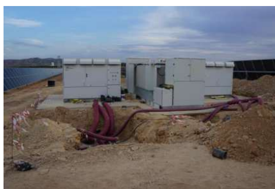
Figura 12 Centro de transformación
