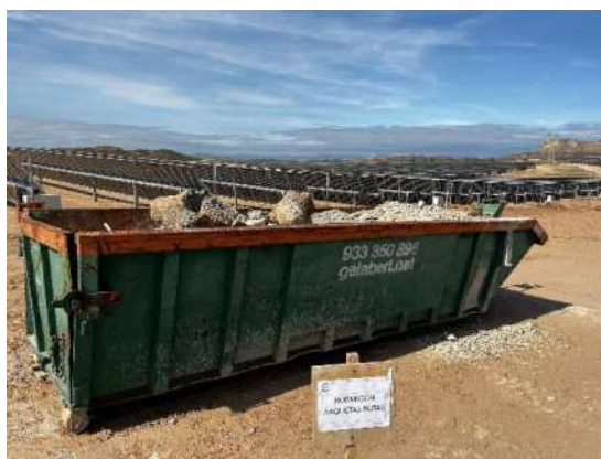
Figura 27 Punto limpio de residuos de hormigón
