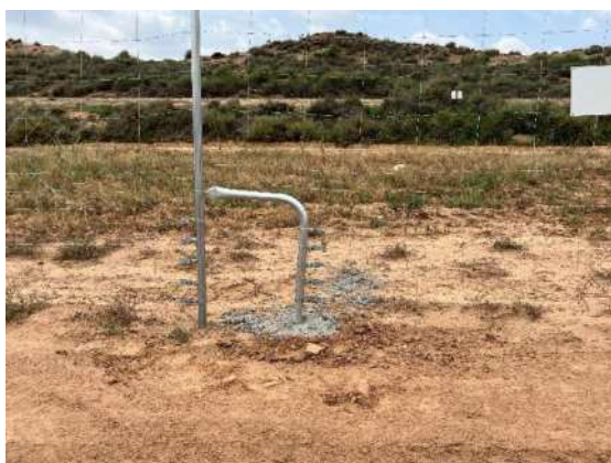
Figura 26 Vertido accidental de hormigón
