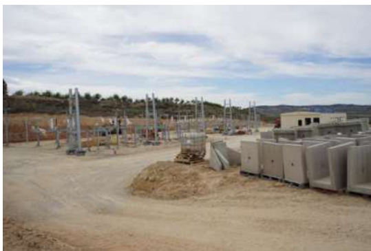
Figura 10 Subestación eléctrica Vallobar
