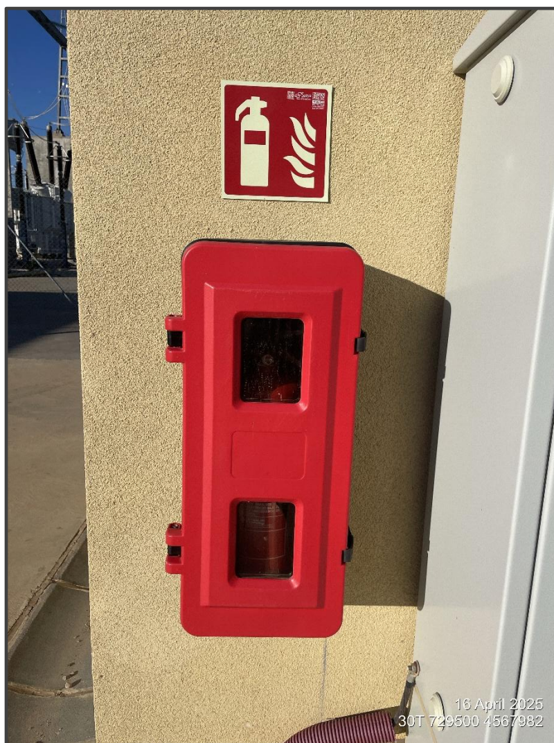
Fotografía 27. Extintores en edificio de control.
