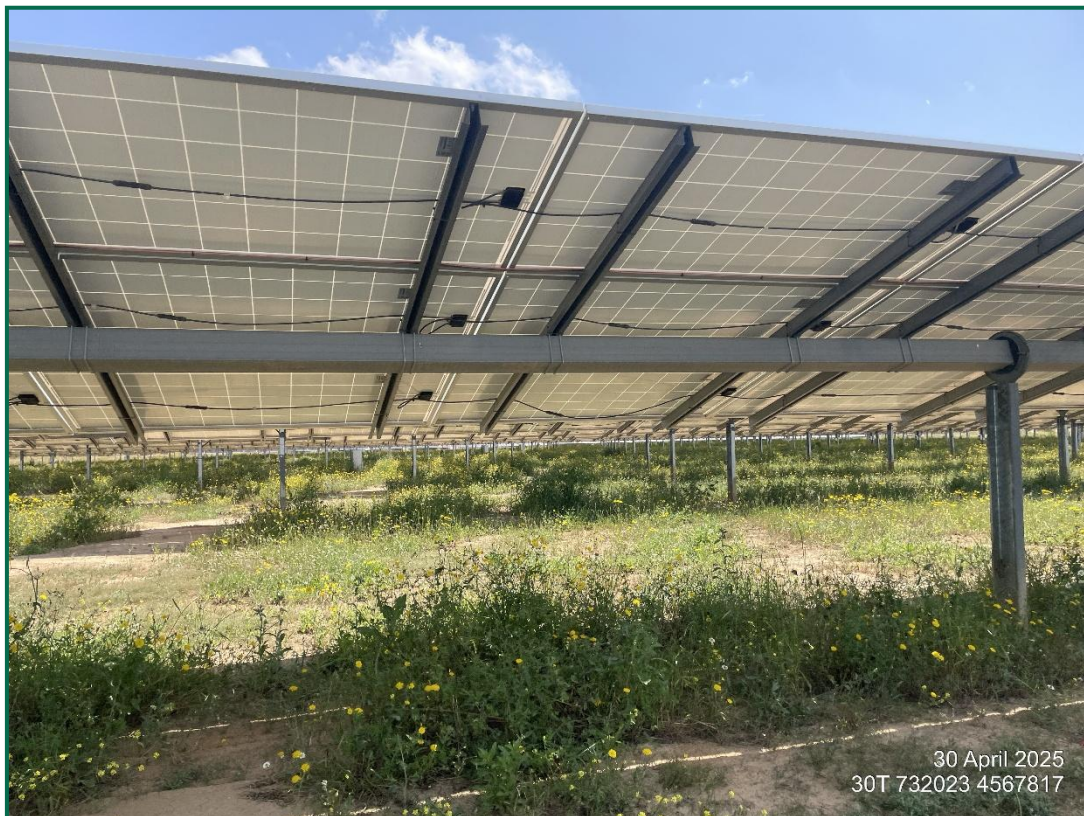
Fotografía 2. Vegetación entre placas actualmente.
