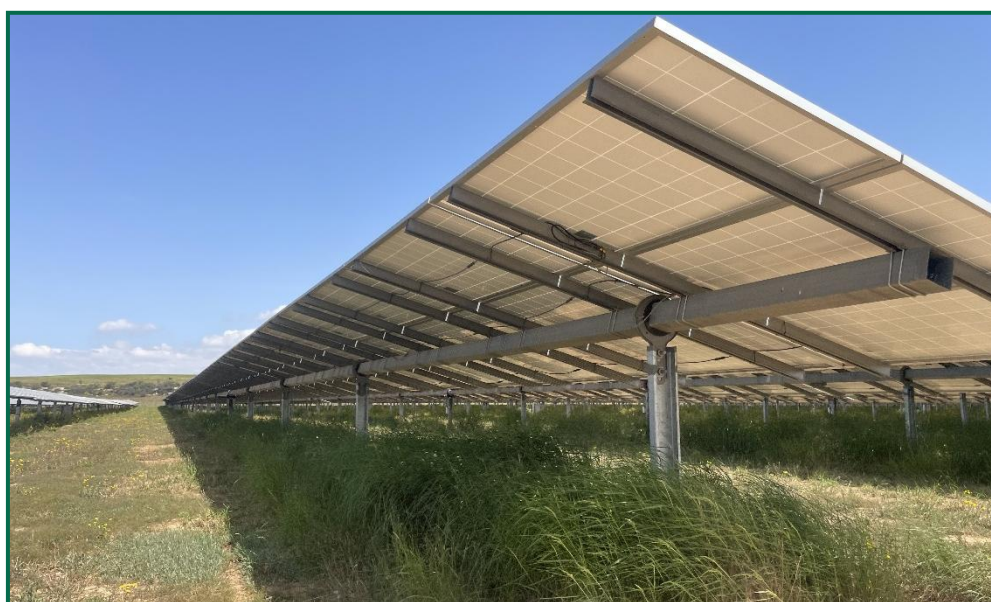
Fotografía 1. Vegetación entre placas actualmente.
