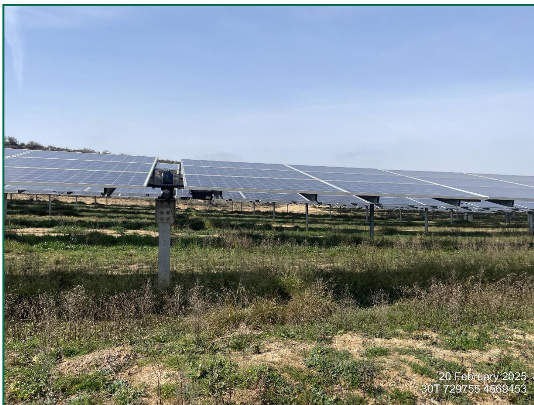
Fotografía 2. Vegetación entre placas actualmente.
