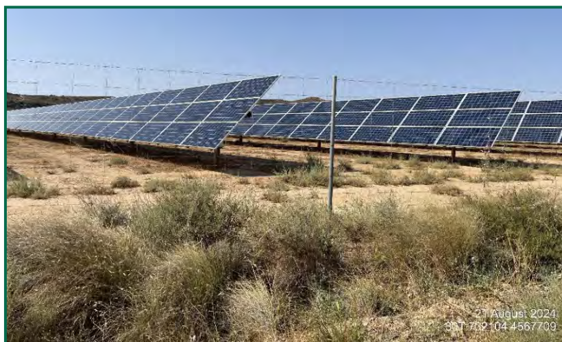
Fotografía 1. Vegetación entre placas actualmente.
