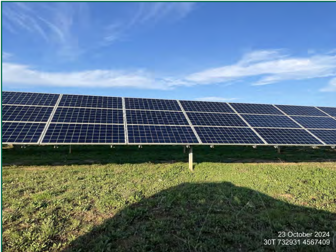
Fotografía 2. Vegetación entre placas actualmente.
