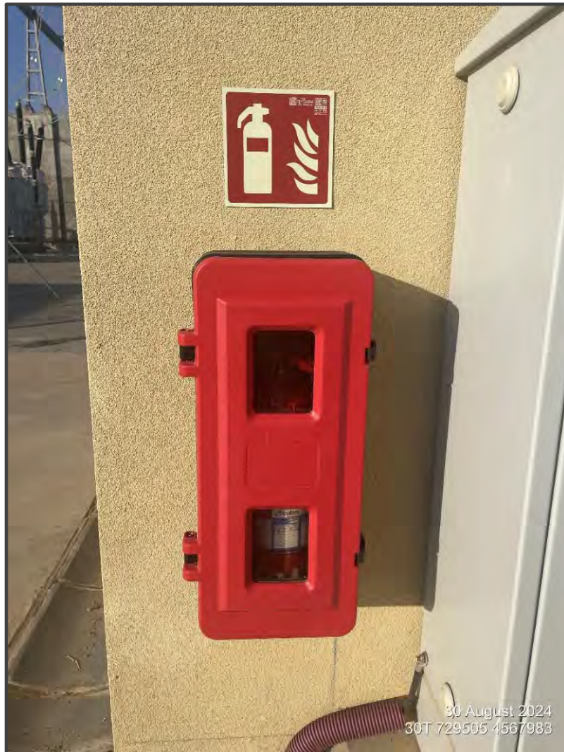
Fotografía 32. Extintores en edificio de control.
