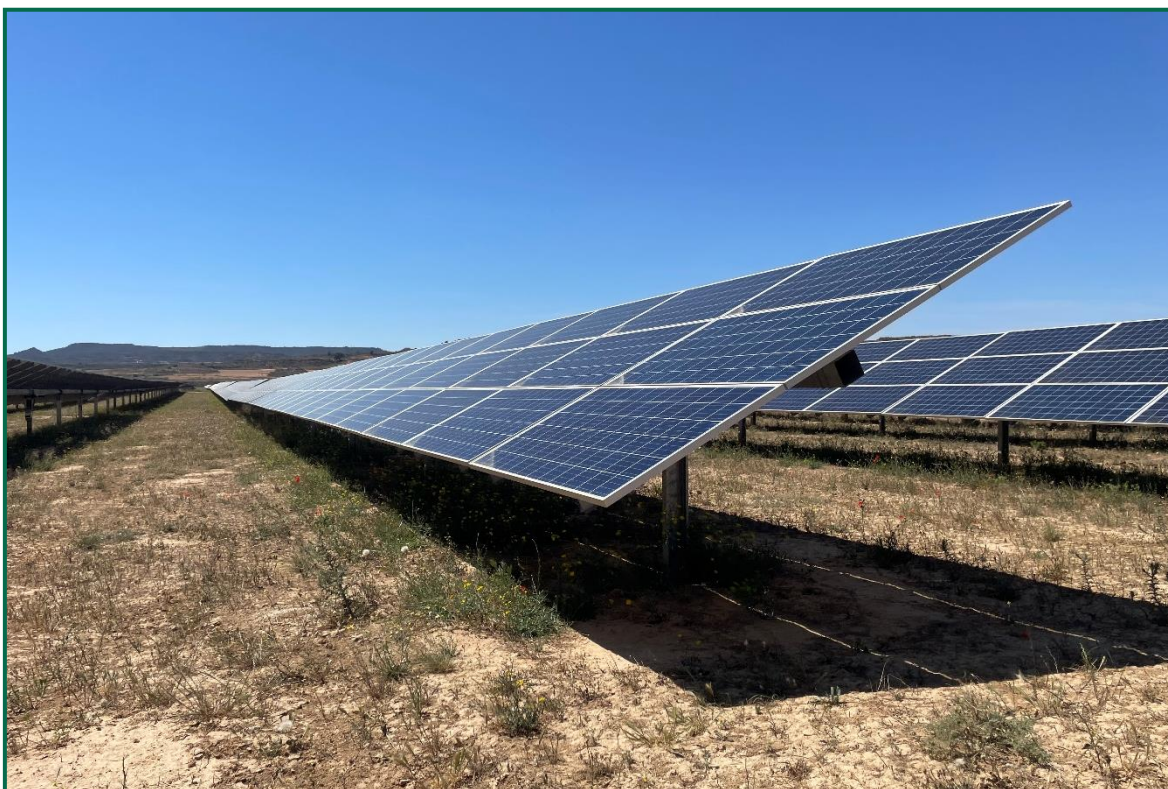
Fotografía 1. Vegetación entre placas actualmente.
