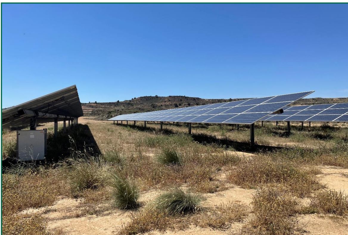
Fotografía 2. Vegetación entre placas actualmente.
