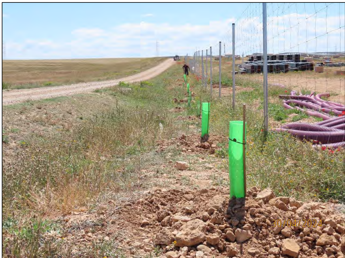
Ilustración 23. Instalación de la pantalla visual.
