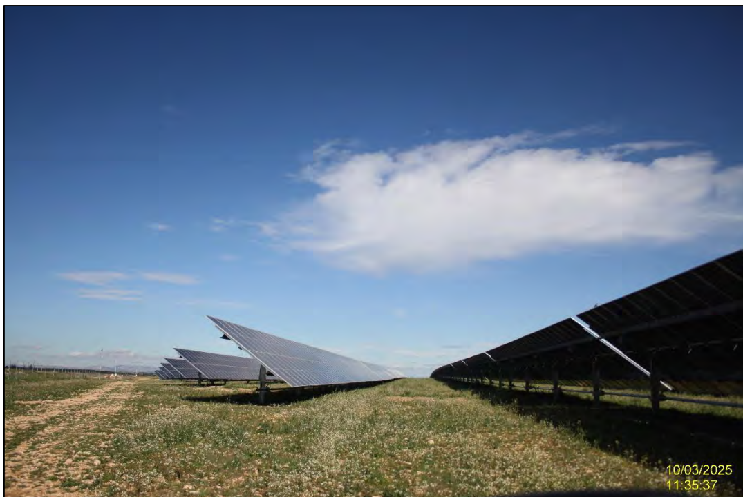
Ilustración 42. Estado actual del parque.
