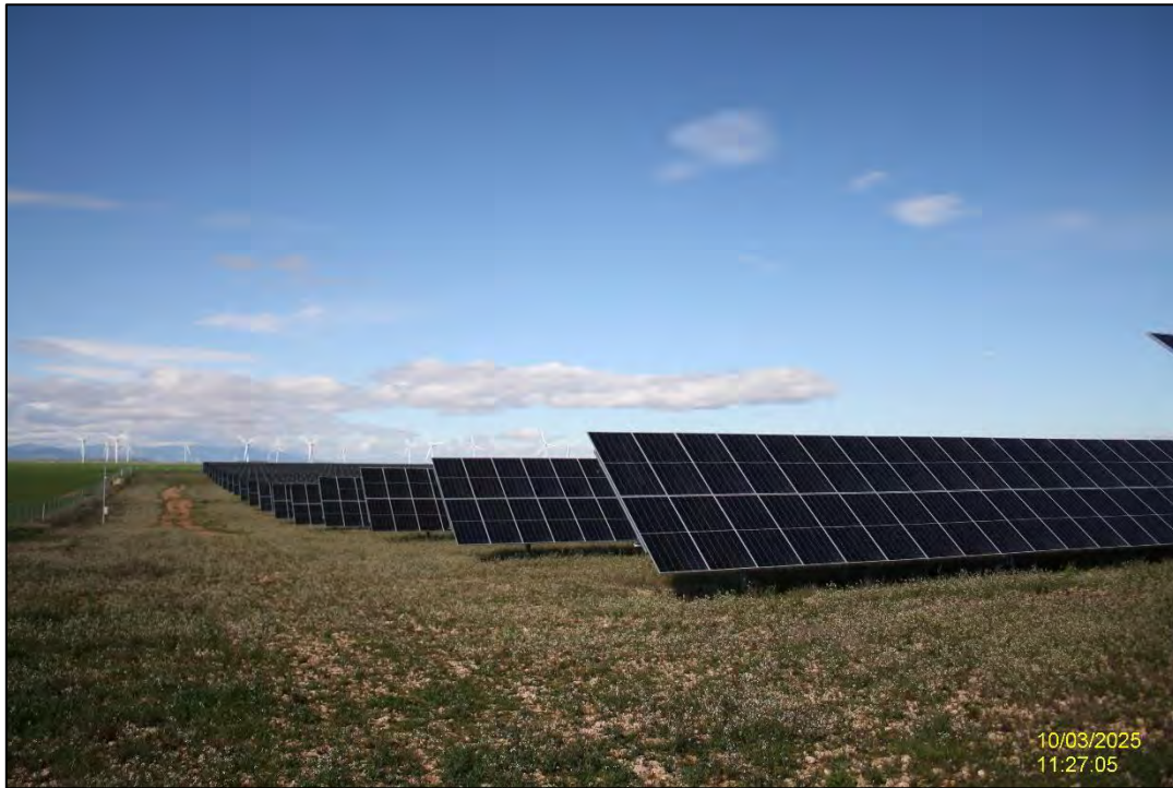
Ilustración 41. Estado actual del parque.
