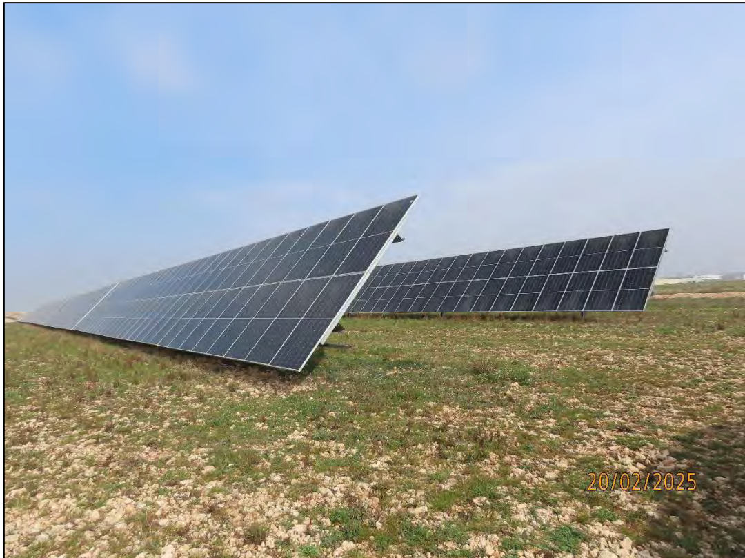
Ilustración 39. Estado actual del parque.
