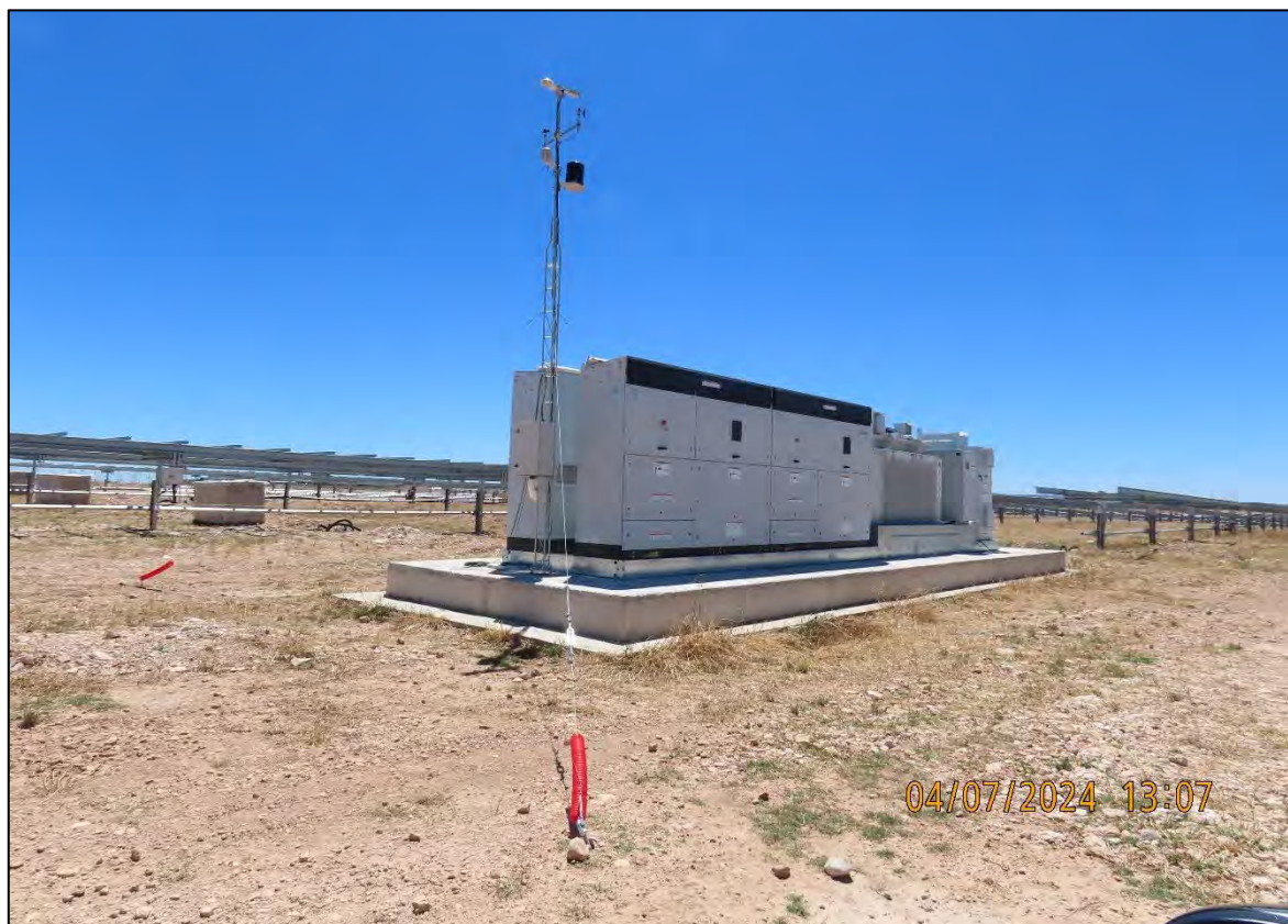
Ilustración 30. Estación meteorológica provisional en Power Station.
