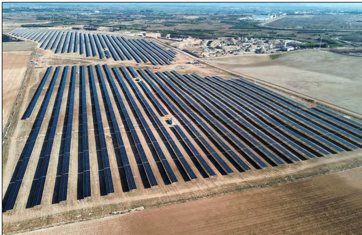
Ilustración 32. Estado del parque.
