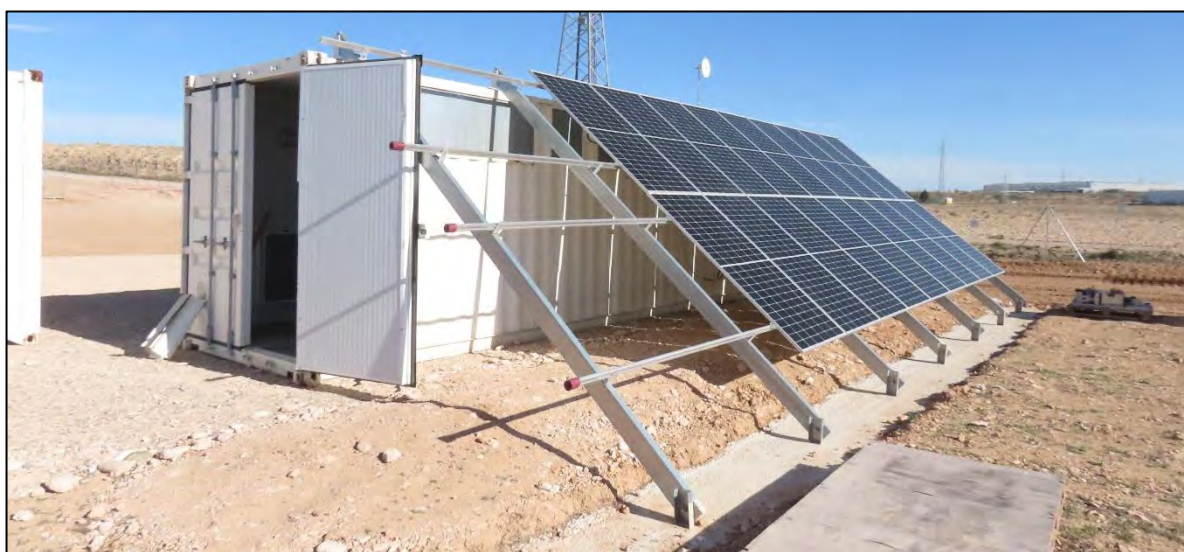
Ilustración 9. Sistema de abastecimiento eléctrico para las casetas de obra.
