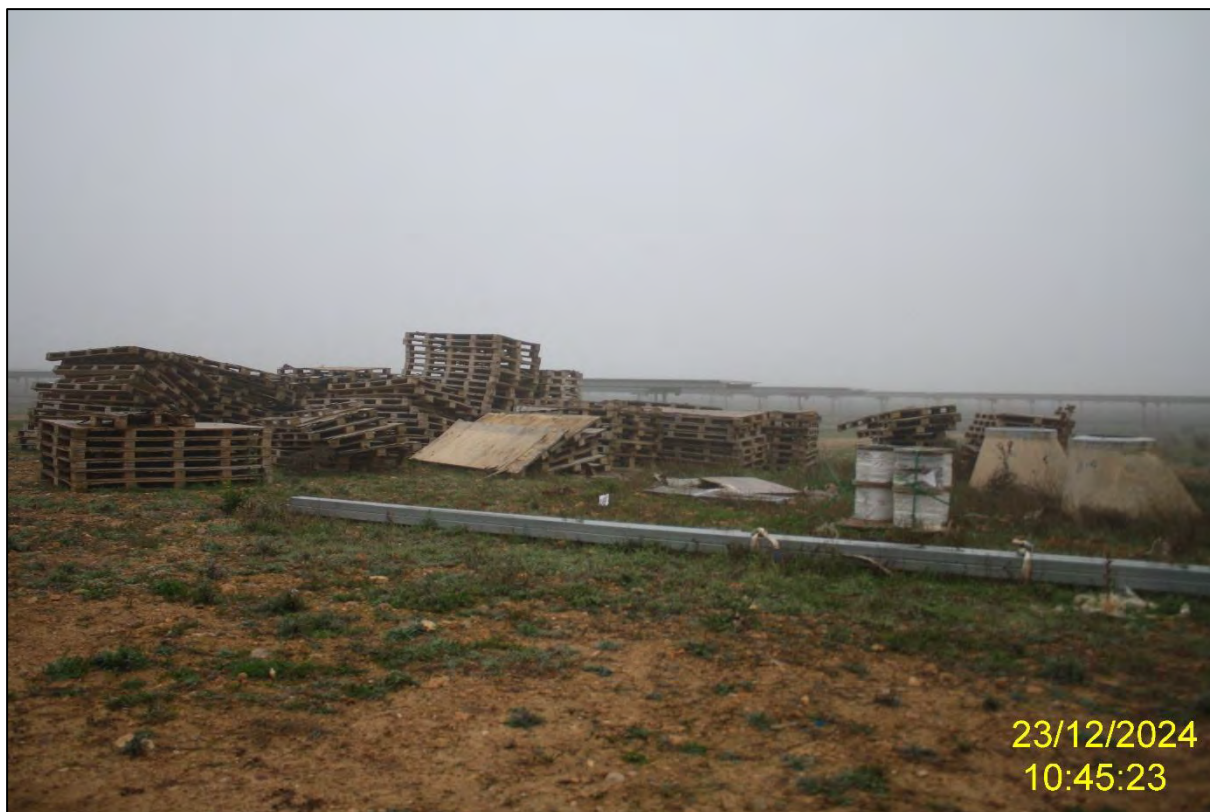
Ilustración 5. Zona de acopio con residuos de distintos materiales.
