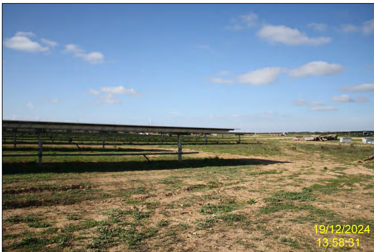
Ilustración 6. Estado actual del parque.
