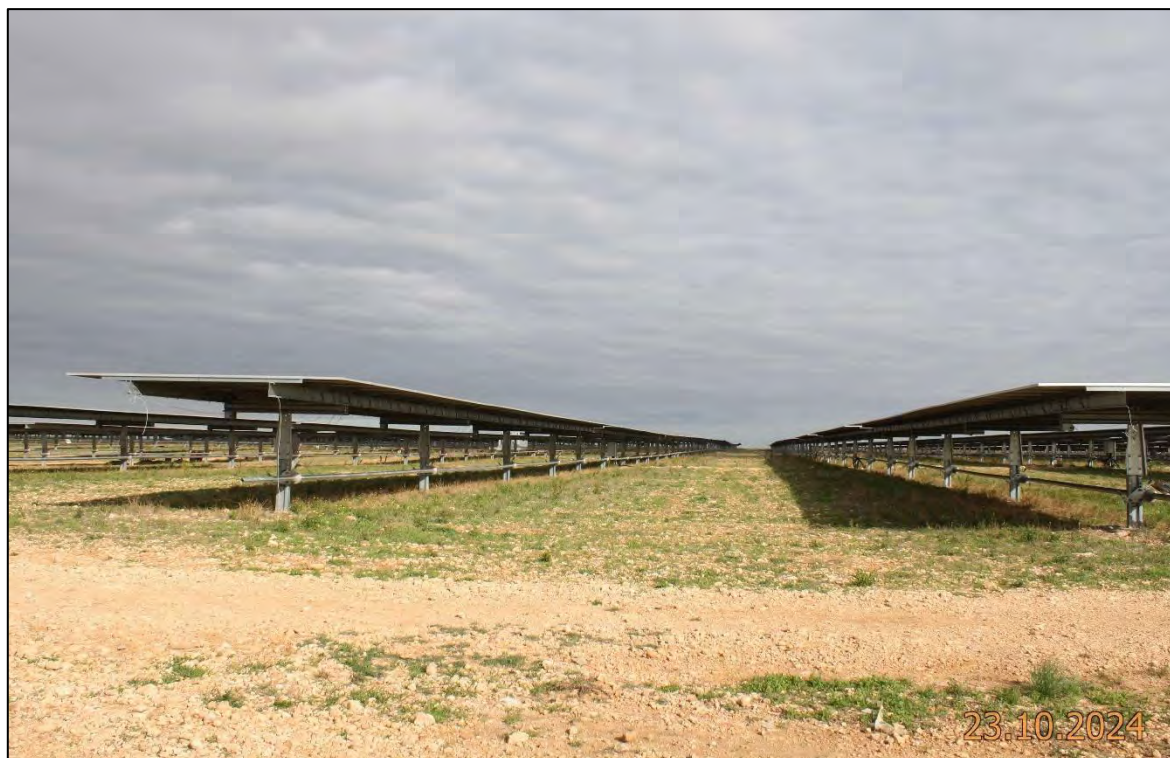
Ilustración 7. Estado actual del parque.
