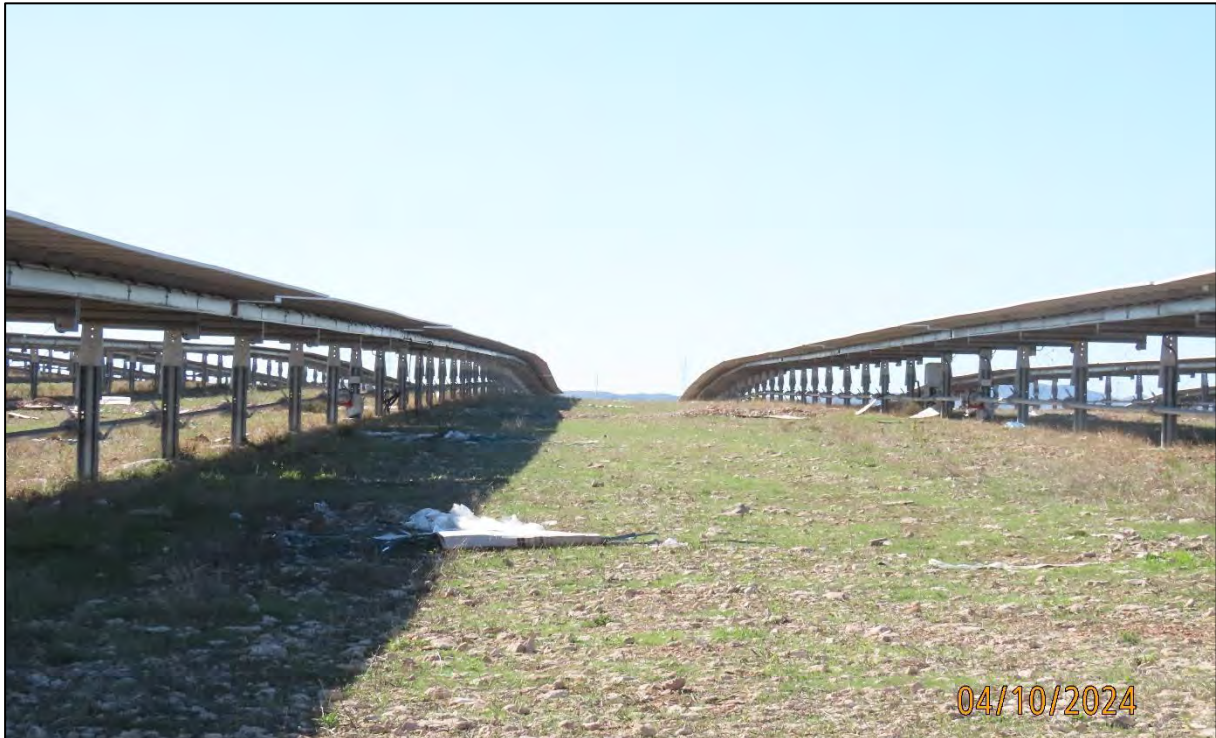
Ilustración 9. Restos de embalajes entre paneles fotovoltaicos.
