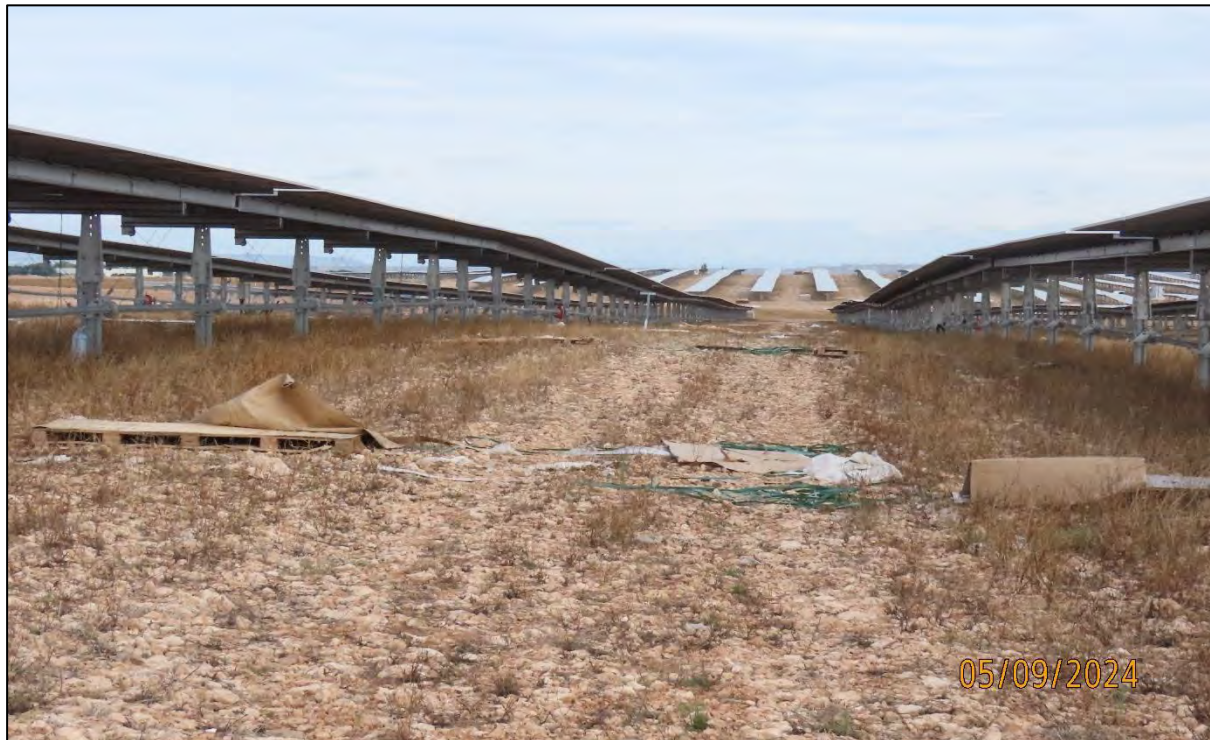
Ilustración 9. Restos de embalajes entre paneles fotovoltaicos.
