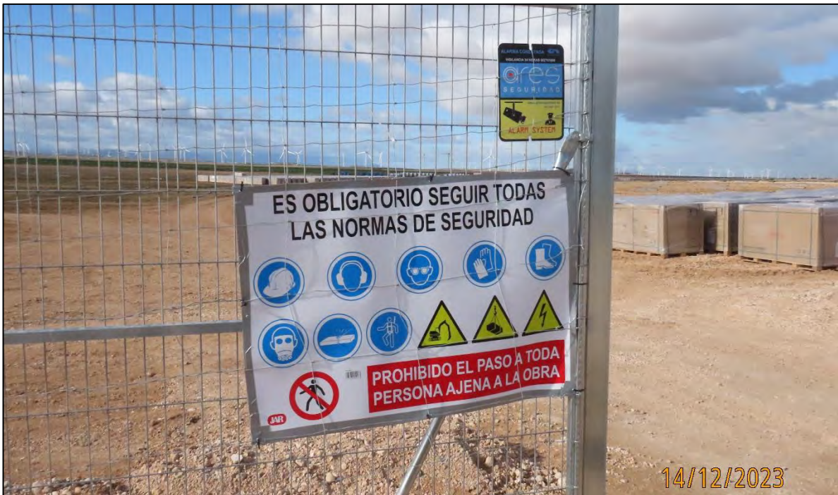
Ilustración 6. Señalización de obra en la entrada de las instalaciones de las PFV.
