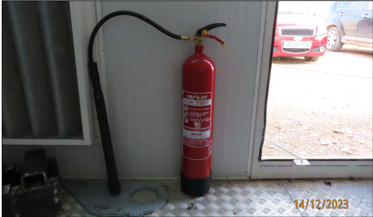
Ilustración 7. Equipo de extinción de incendios homologado.
