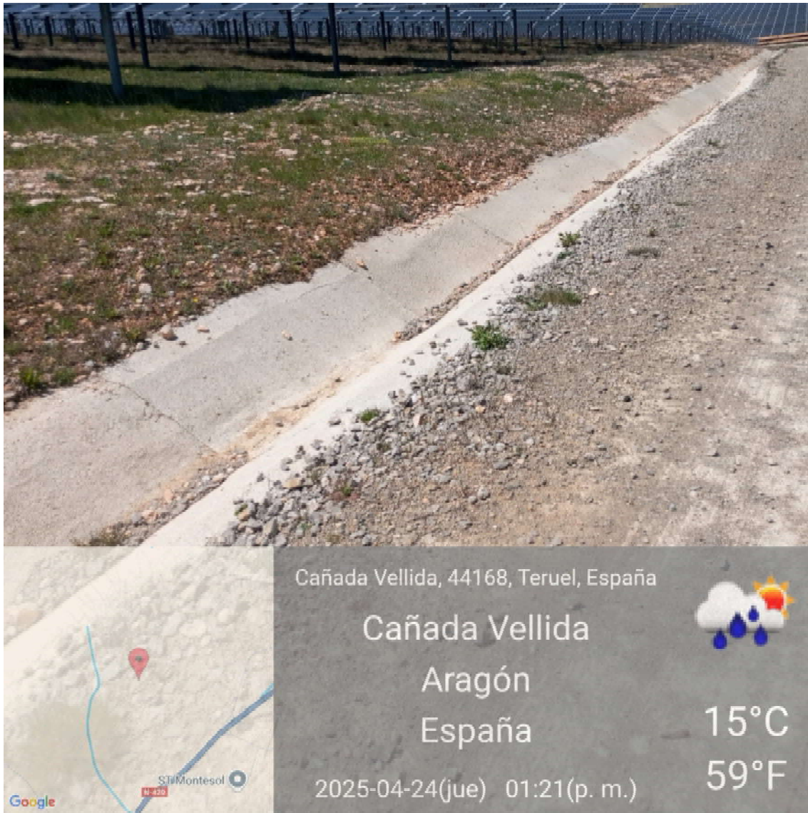
Ilustración 6. Cunetas cementadas limpias en poligonal 1.
