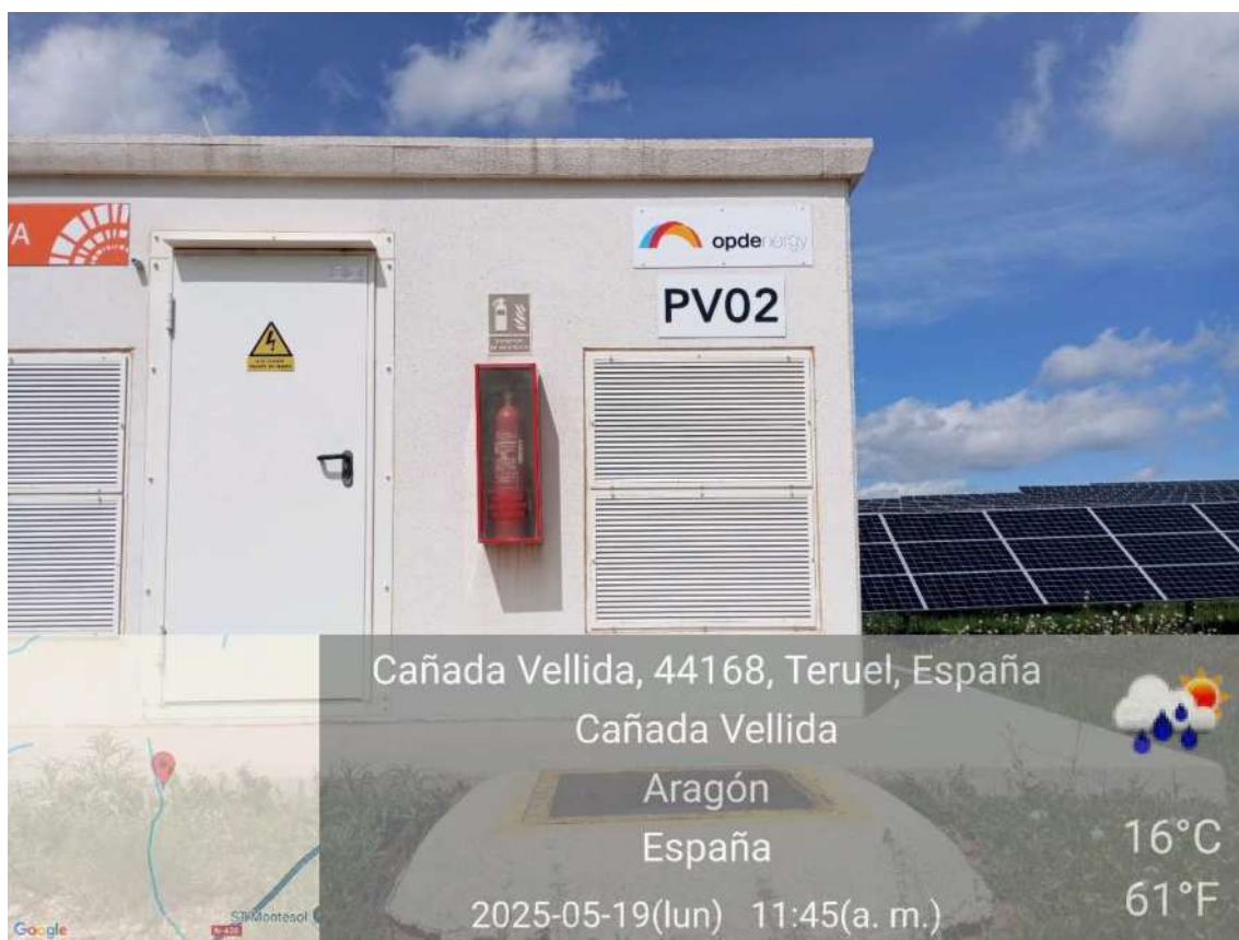
Ilustración 7. Extintores presentes en el exterior de los centros transformadores.
