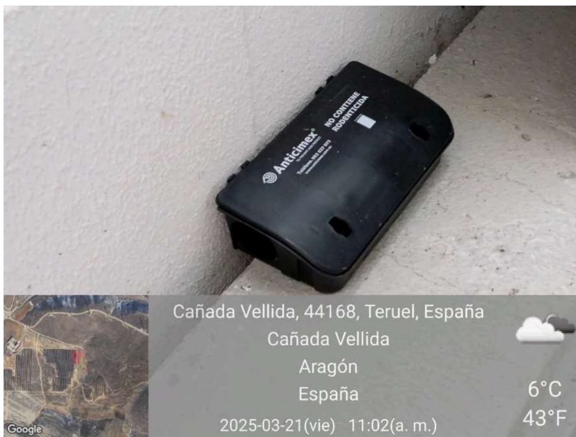
Ilustración 2. Portacebos en centros transformadores.
