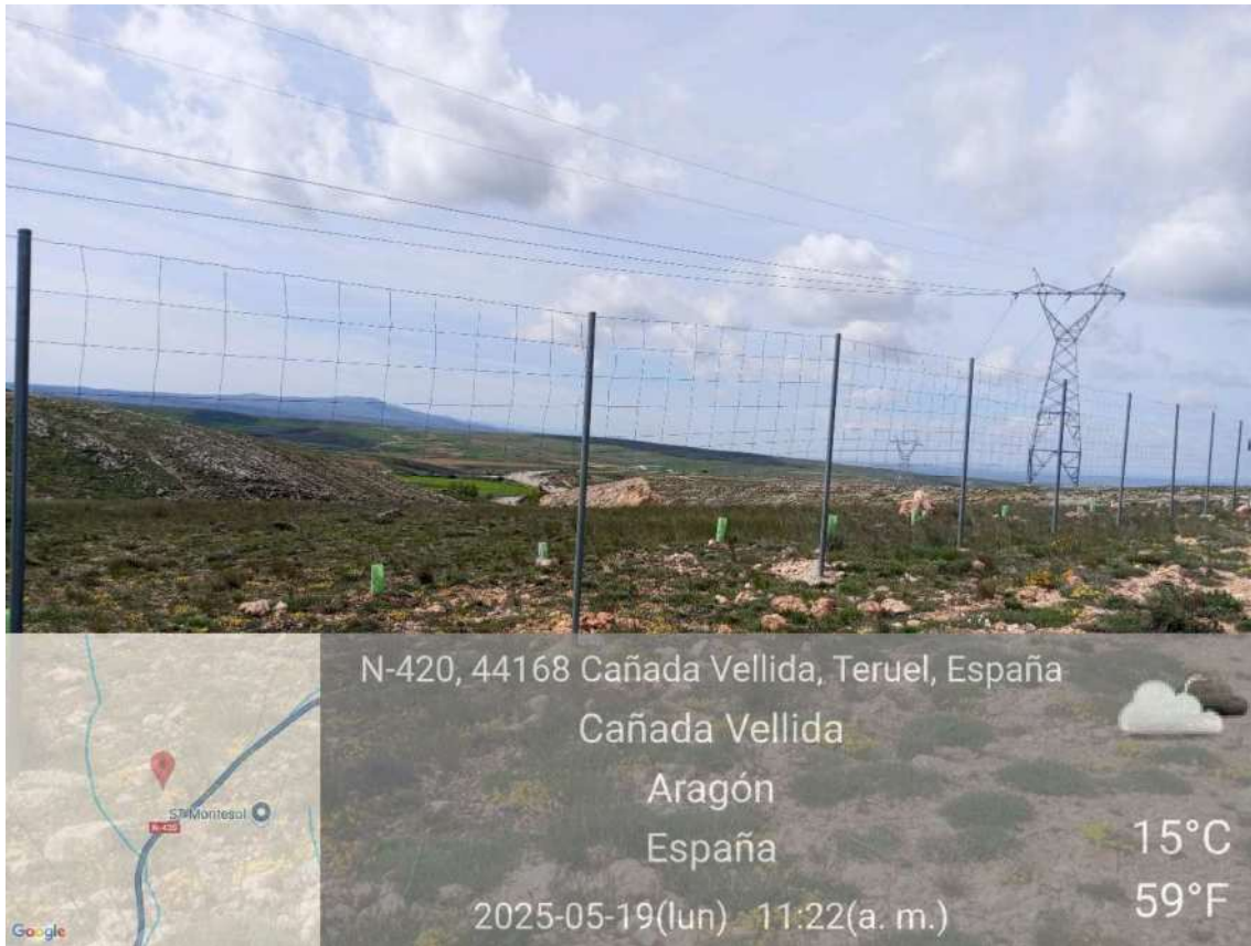
Ilustración 9. Placas anticollisión ausentes en poligonal 1.
