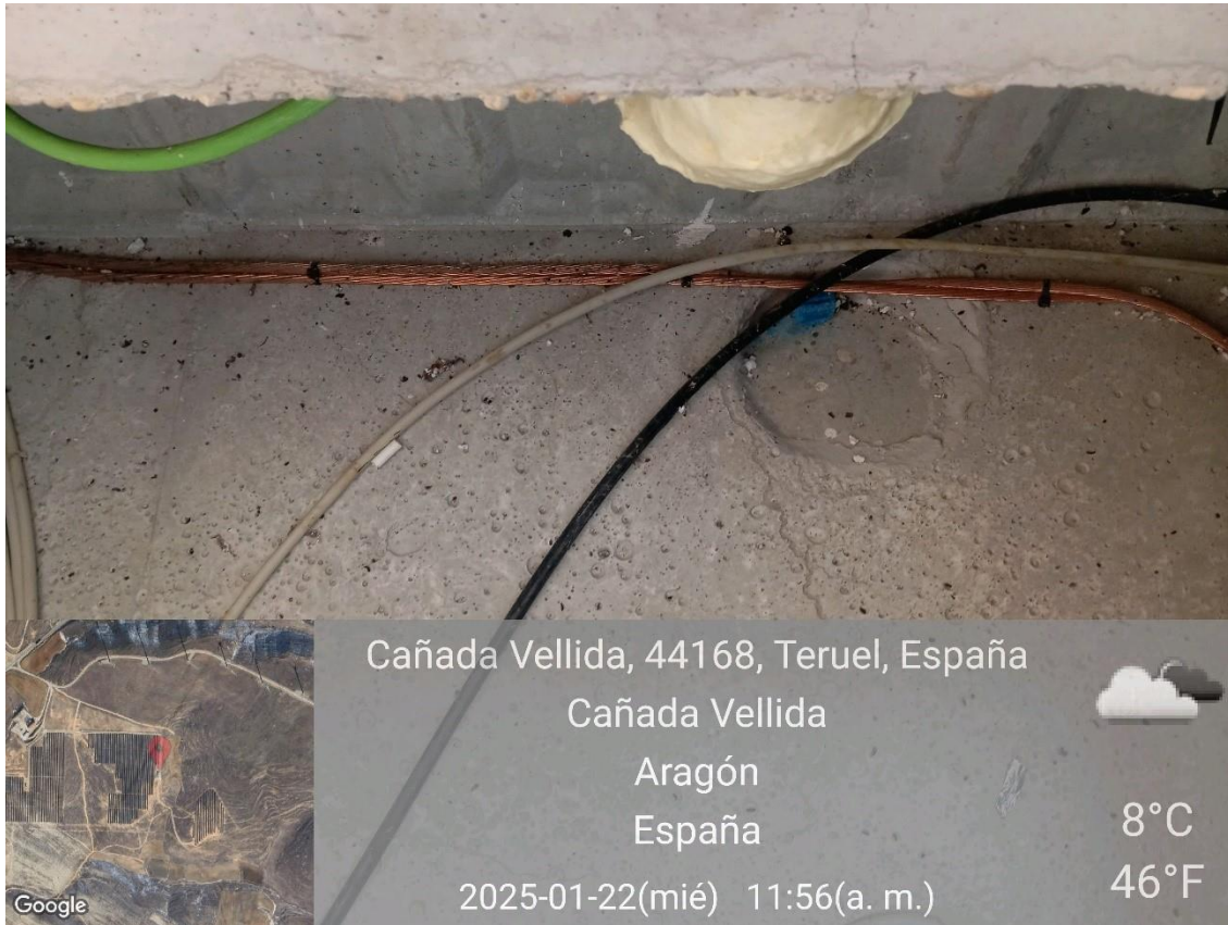
Ilustración 9. Arquetas de los centros transformadores con presencia de excrementos y veneno.
