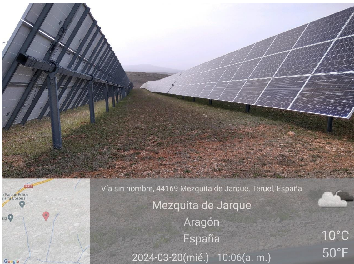
Ilustración 2. Cobertura vegetal bajo placas.
