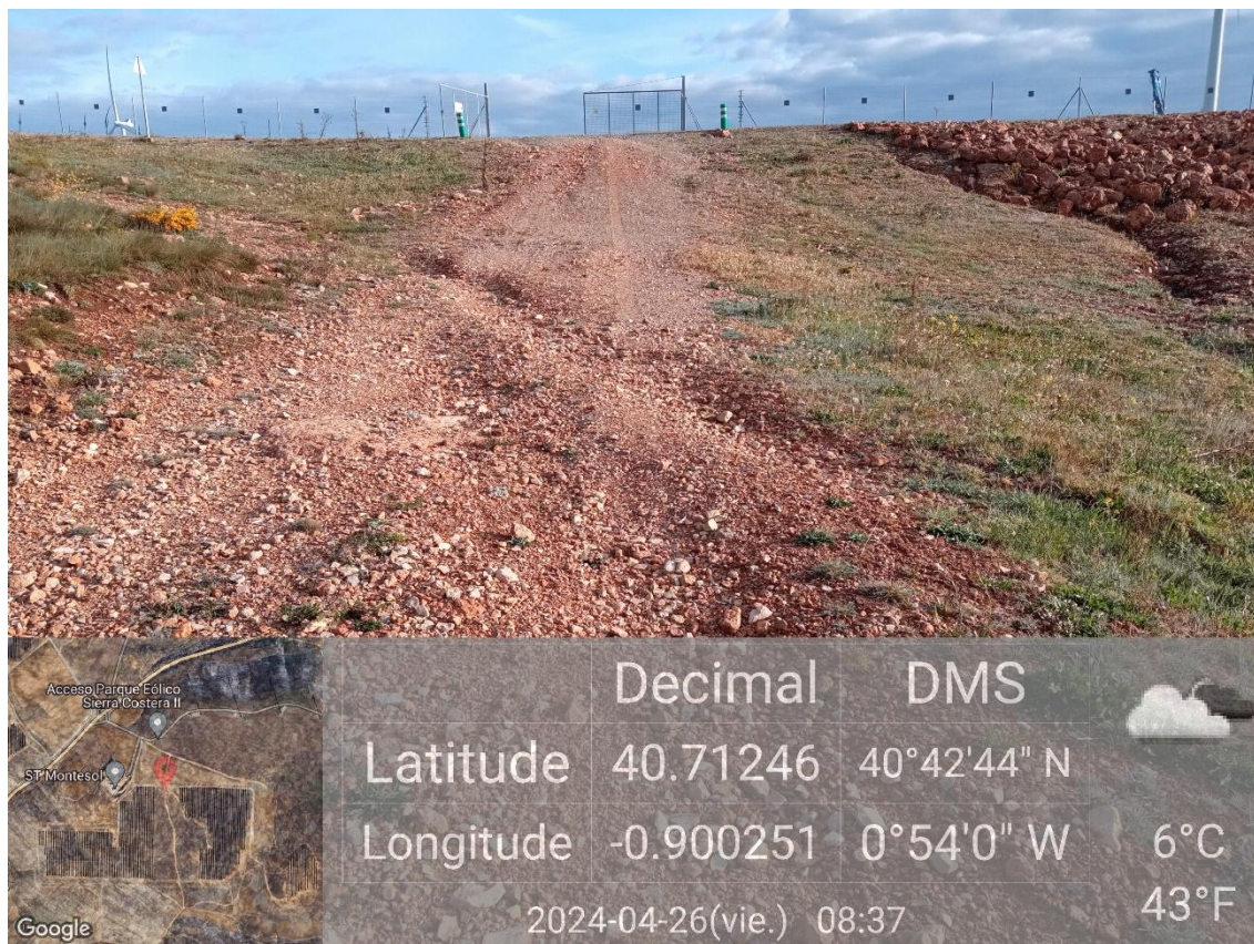
Ilustración 4. Erosión del camino del campo 2.
