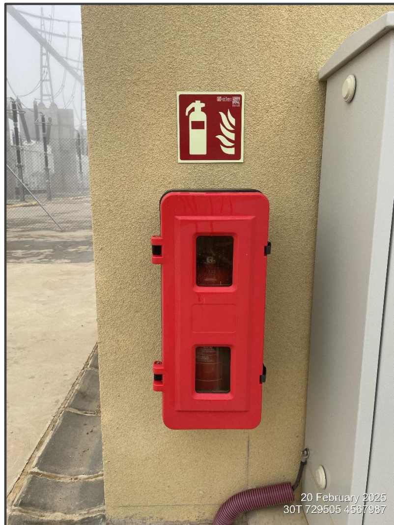
Fotografía 31. Extintores en edificio de control.
