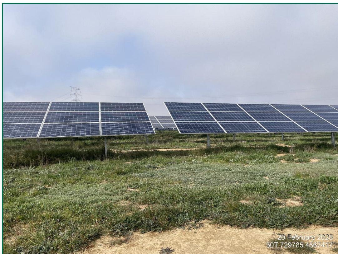
Fotografía 2. Vegetación entre placas actualmente.
