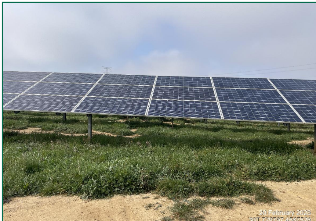
Fotografía 1. Vegetación entre placas actualmente.
