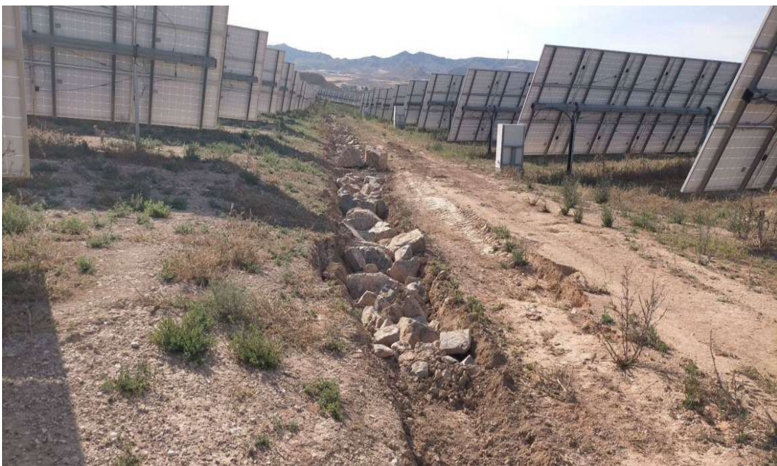
Fotografía 4: Red de drenaje interna
