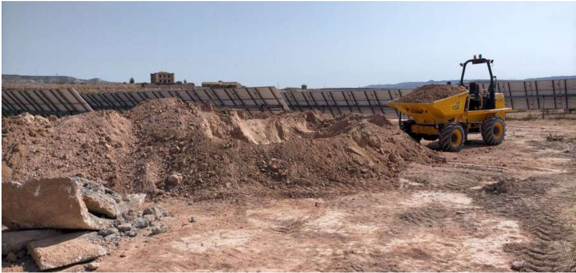
Fotografía 7. Uno de los acopios de materiales resultantes de la obra de reparación
