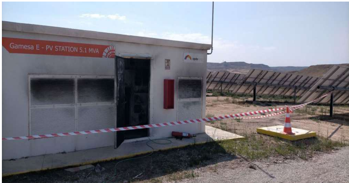
Fotografía 26. CT-8 estabilizado tras el accidente
