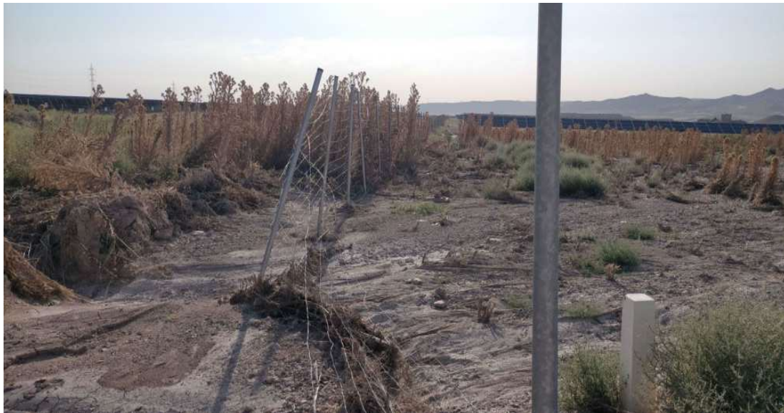
Fotografía 22. Rotura del vallado perimetral (localización: 30N 658412.7 4595510)
