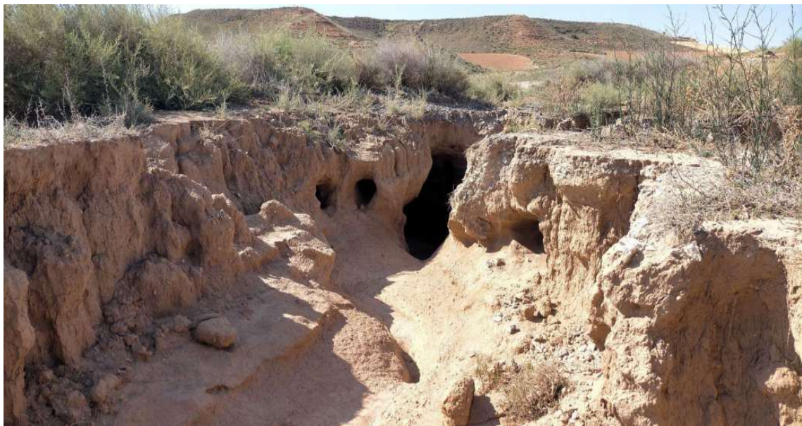
Fotografía 10. Efecto erosivo 1) (localización: 30N 659777 4594951)
