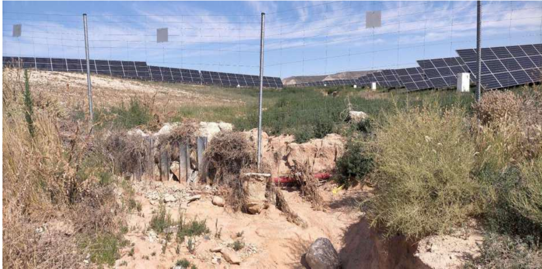
Fotografía 11. Efecto erosivo 2) (localización: 30 N 659966 4595133)
