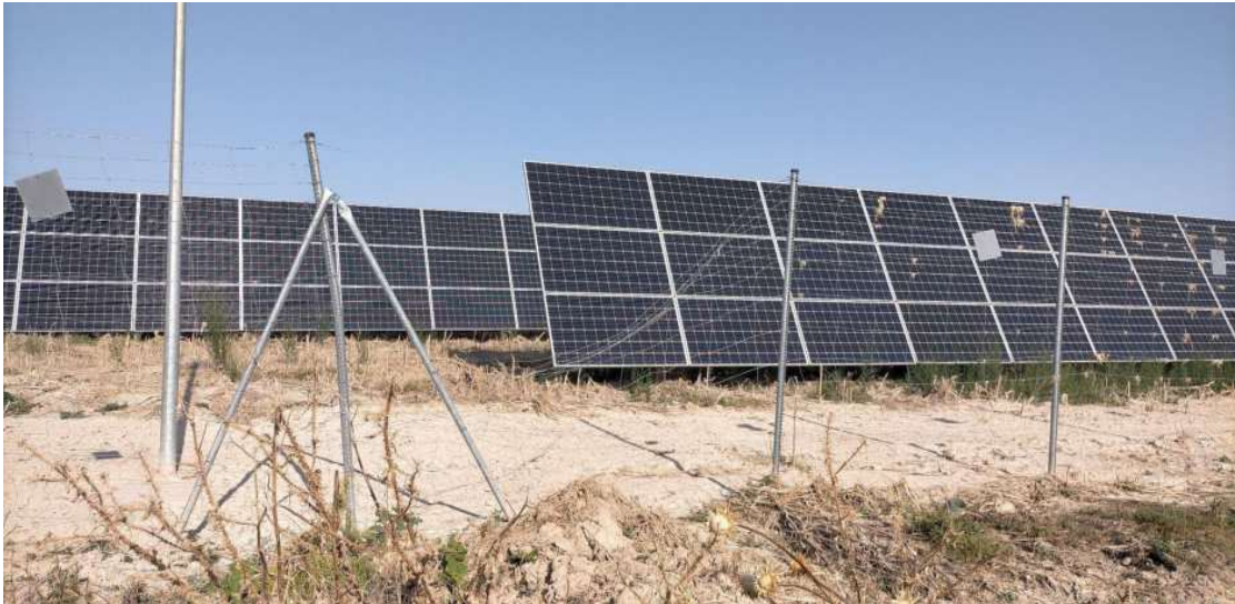
Fotografía 21. Rotura del vallado perimetral (localización: 30N 659293.9 4594936.3)
