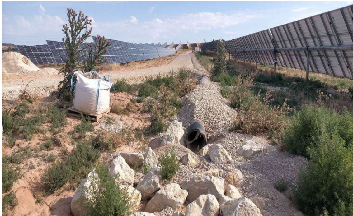
Fotografía 5: Red de drenaje interna
