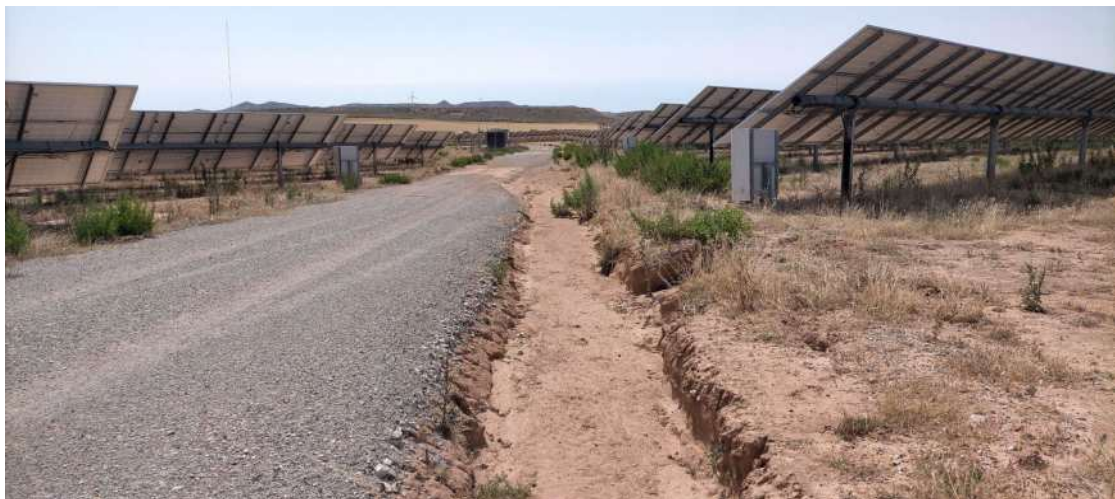
Fotografía 4. Red de drenaje del vial interno colmatada de sedimento
