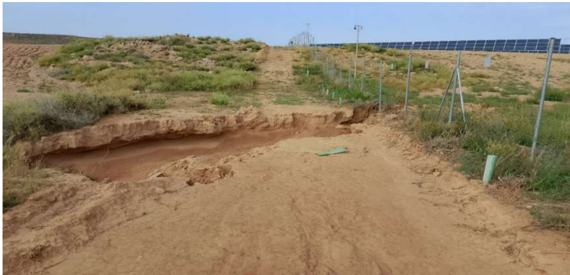
Fotografía 13. Efecto erosivo 3) (fotografía tomada en el mes de septiembre con vista al vial exterior, localización: 30N 659916 4595083)
