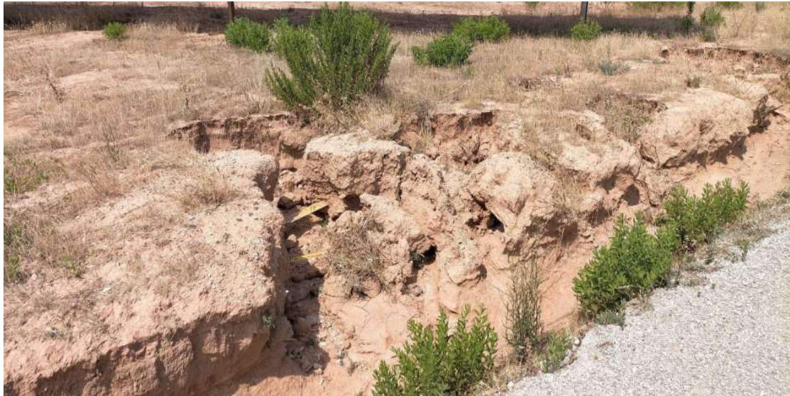
Fotografía 3. Cárcavo generado por la erosión en el interior de la PFV
