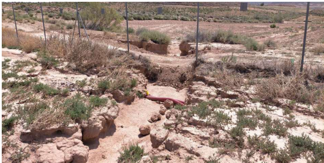
Fotografía 12. Efecto erosivo 3) (fotografía tomada en el mes de julio con vista al vial exterior, localización: 30N 659916 4595083)
