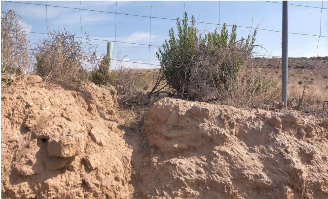
Fotografía 9: Paso de fauna de la PFV
