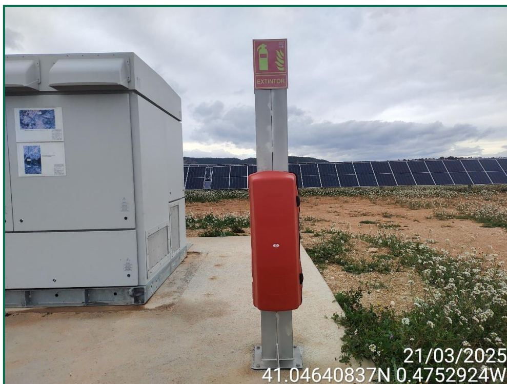
Fotografía 18. Extintor junto a inversor.
