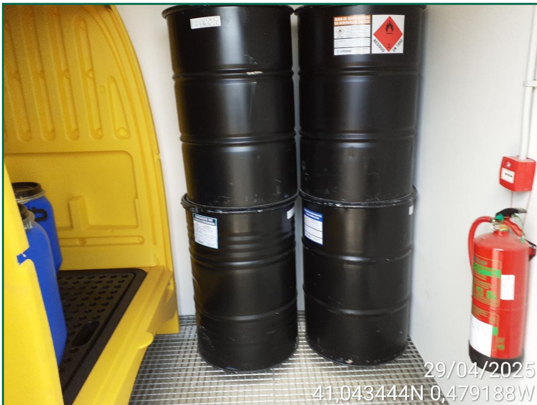
Fotografía 17. Contenedores para residuos peligrosos.
