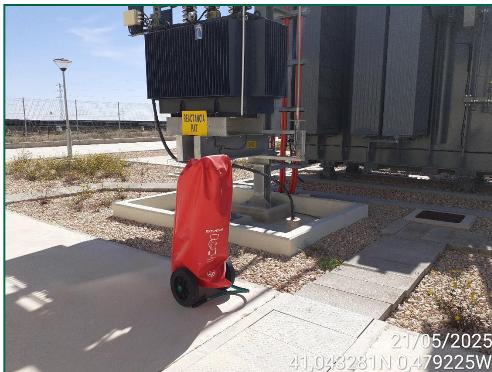
Fotografía 19. Extintor junto a transformador en la subestación.
