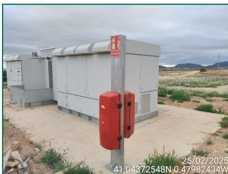
Fotografía 19. Extintor junto a inversor.
