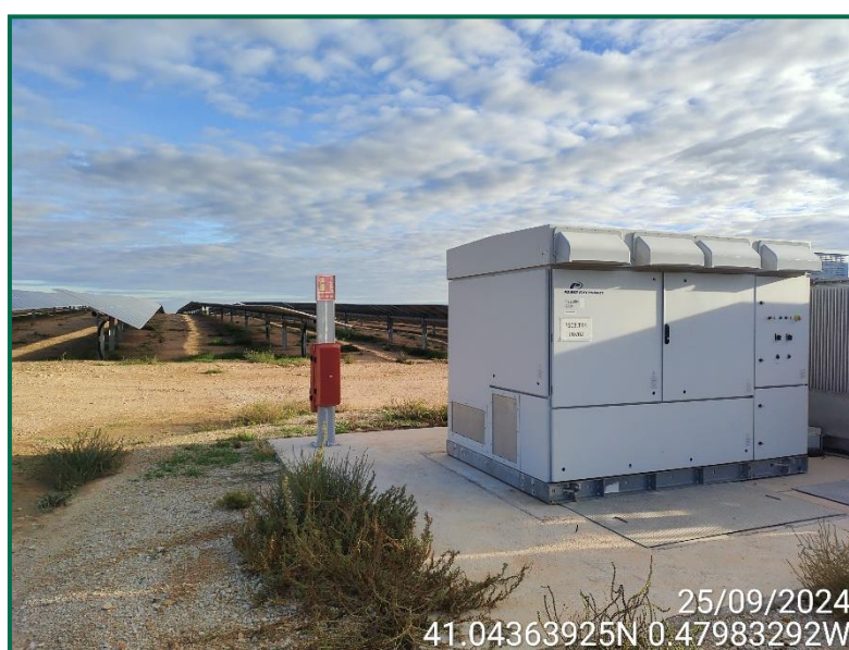
Fotografía 17. Extintor junto a inversor.
