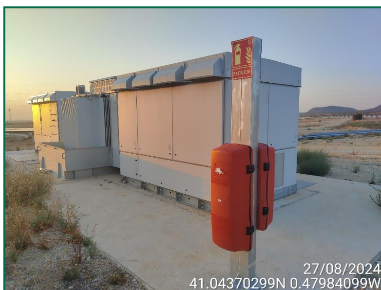
Fotografía 17. Extintor junto a inversor.
