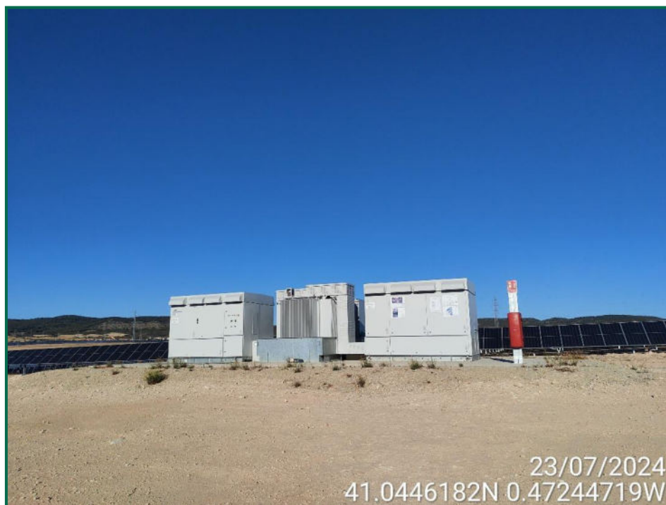
Fotografía 40. Extintor junto a inversor.
