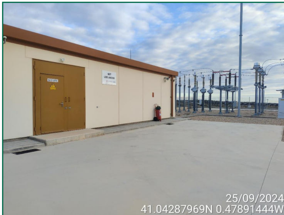
Fotografía 39. Extintor en subestación.
