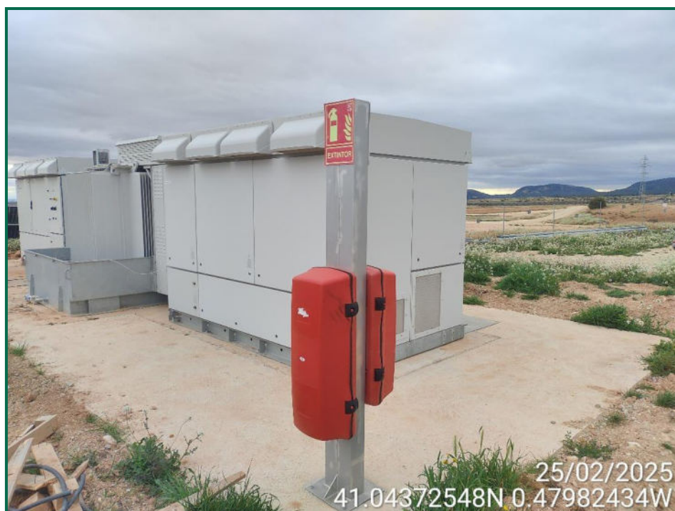
Fotografía 38. Extintor junto a inversor.
