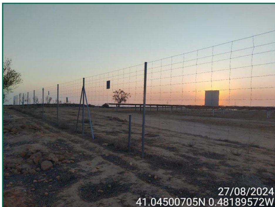
Fotografía 36. Vallado perimetral con placas anticolidión.
