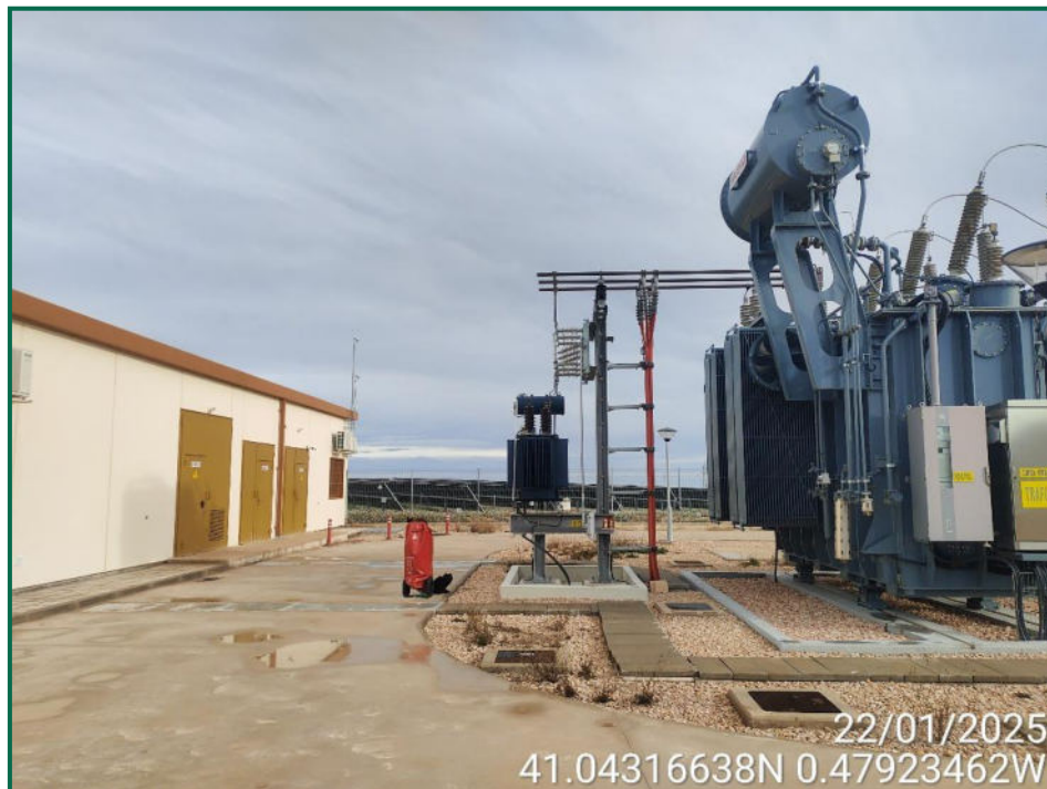
Fotografía 37. Equipo extintor junto a transformador.
