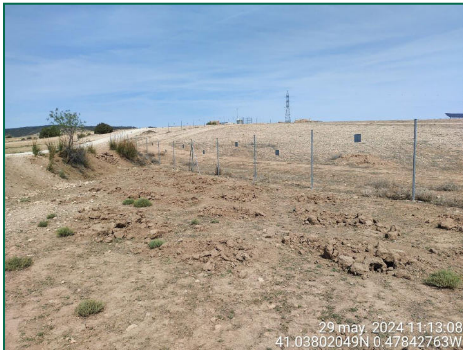
Fotografía 35. Vallado perimetral con placas anticolidión.
