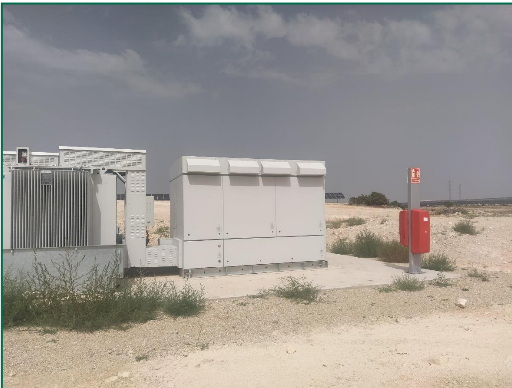
Fotografía 35. Extintor junto a inversores.
