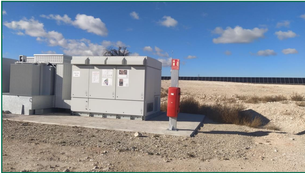
Fotografía 34. Extintor junto a inversores.
