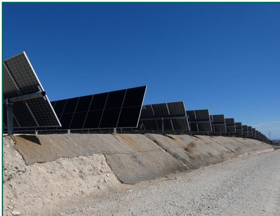
Fotografía 8. Talud con malla de coco durante el invierno.
