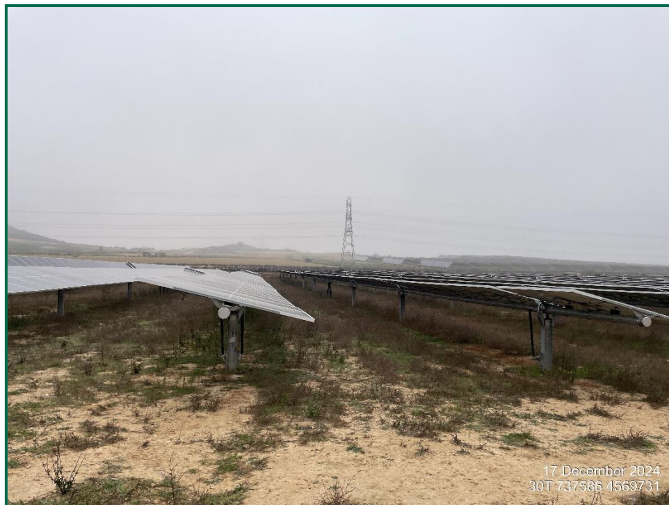
Fotografías 3. Vegetación entre placas actualmente.
