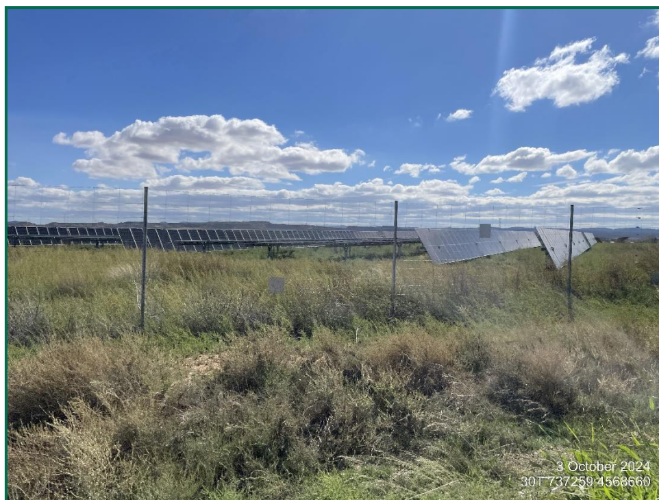
Fotografías 5. Vegetación entre placas actualmente.
