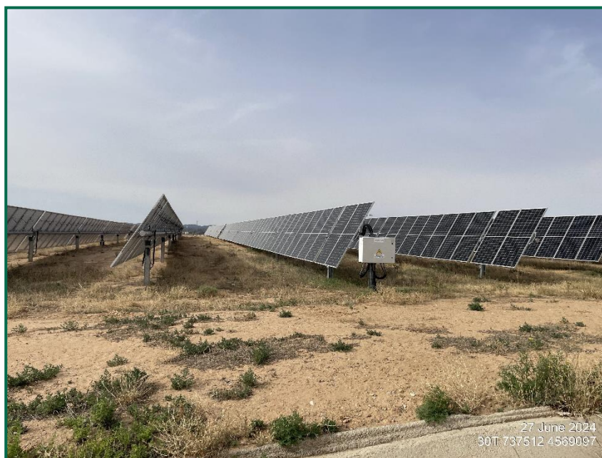
Fotografías 2. Vegetación entre placas actualmente.
