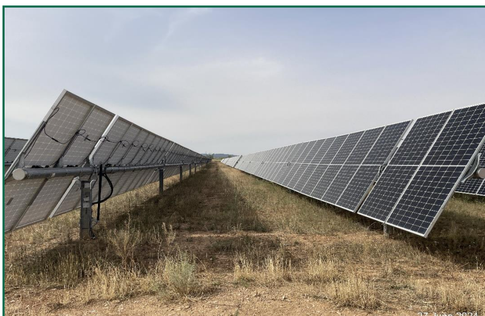
Fotografías 1. Vegetación entre placas actualmente.
