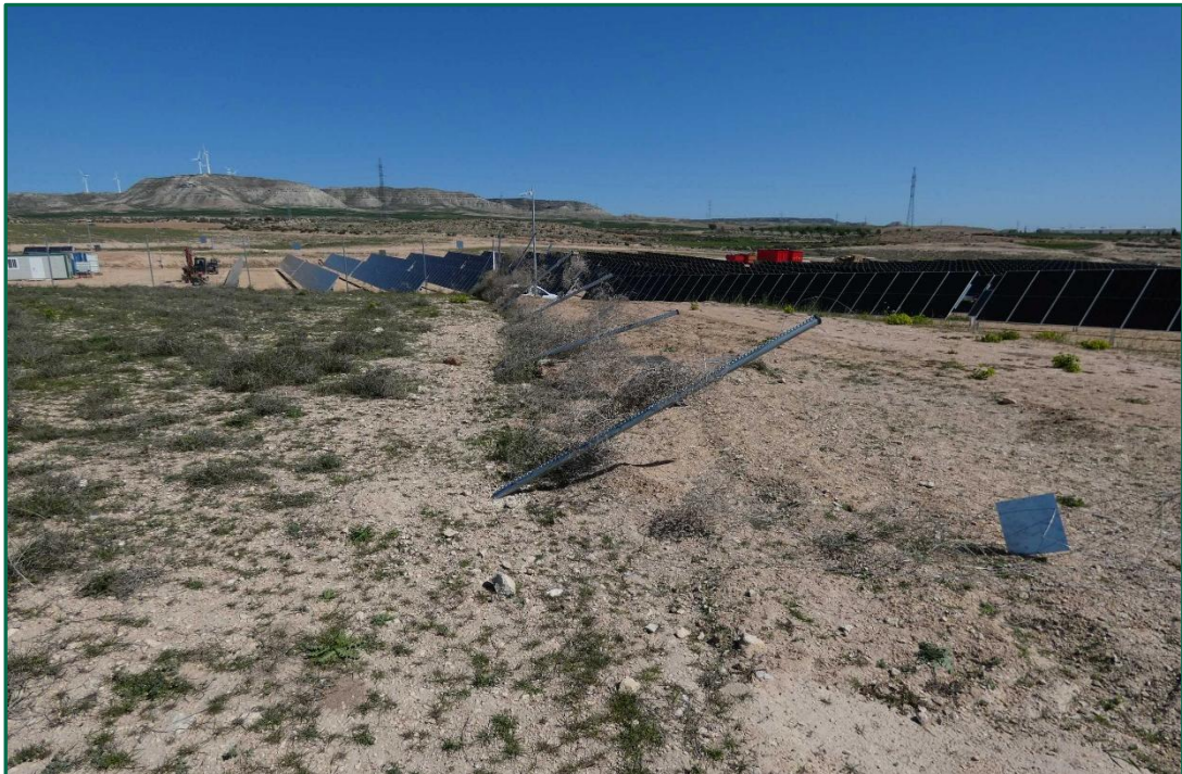
Fotografía 3. Vallado perimetral tumbado por el viento en primavera de 2024.
