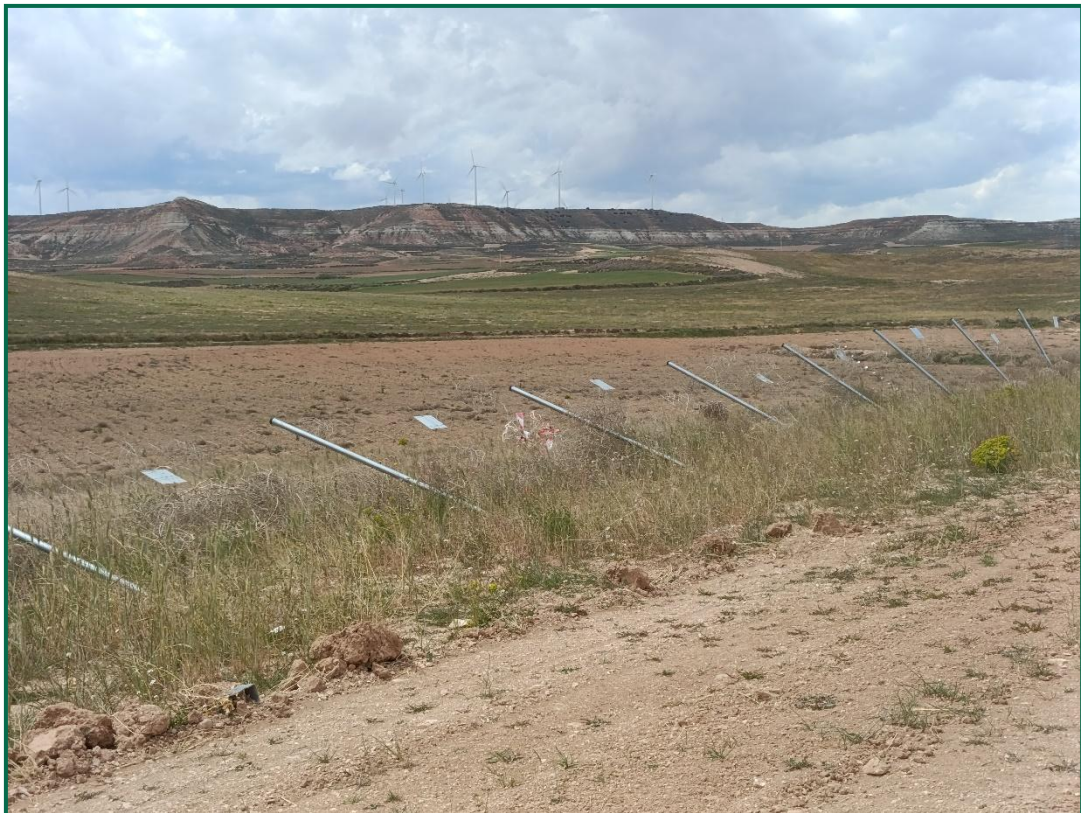
Fotografía 4. Vallado perimetral tumbado por el viento en primavera de 2024.
