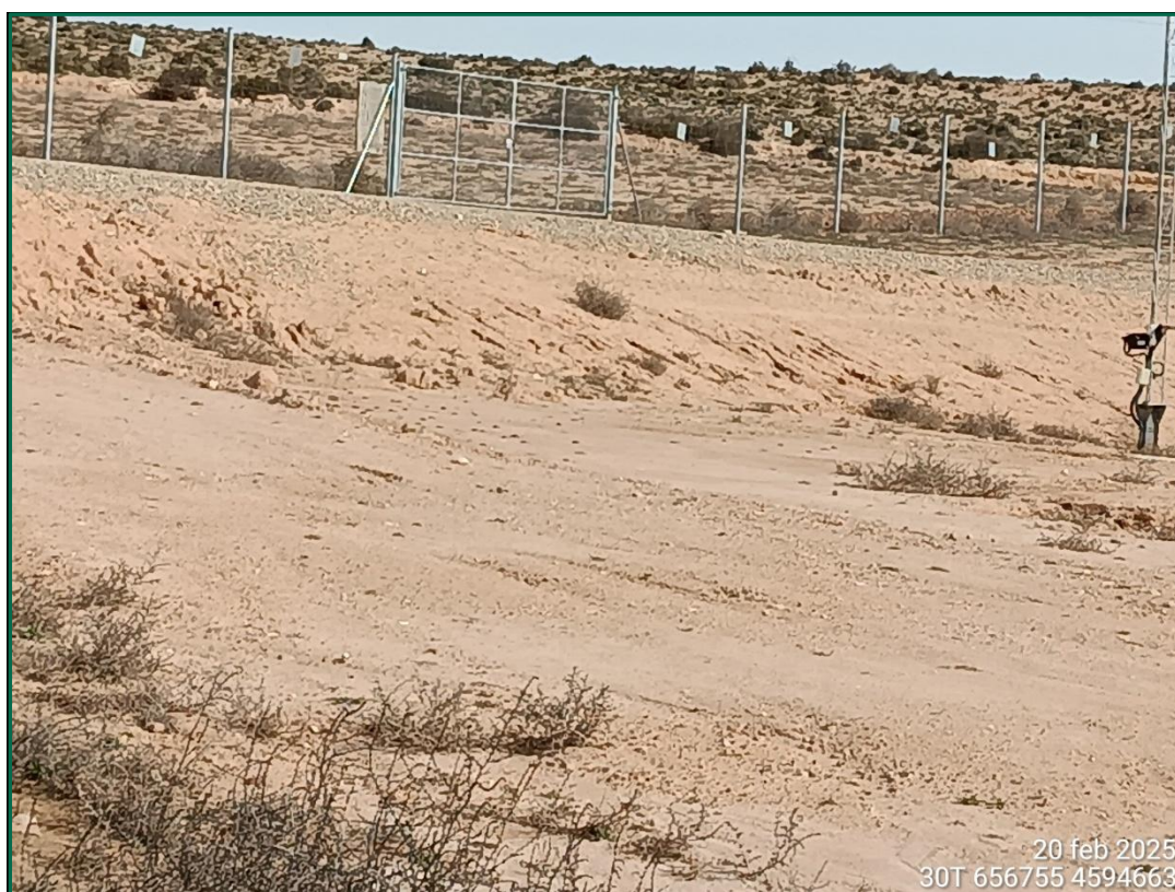
Fotografía 3. Erosión junto al vallado.
