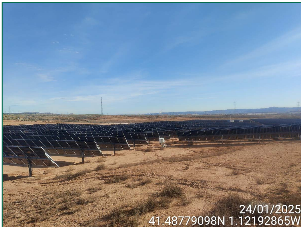
Fotografía 4. Erosión entre las placas fotovoltaicas.
