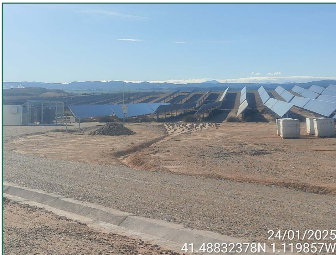
Fotografía 7. Zonas de acumulación de agua.
