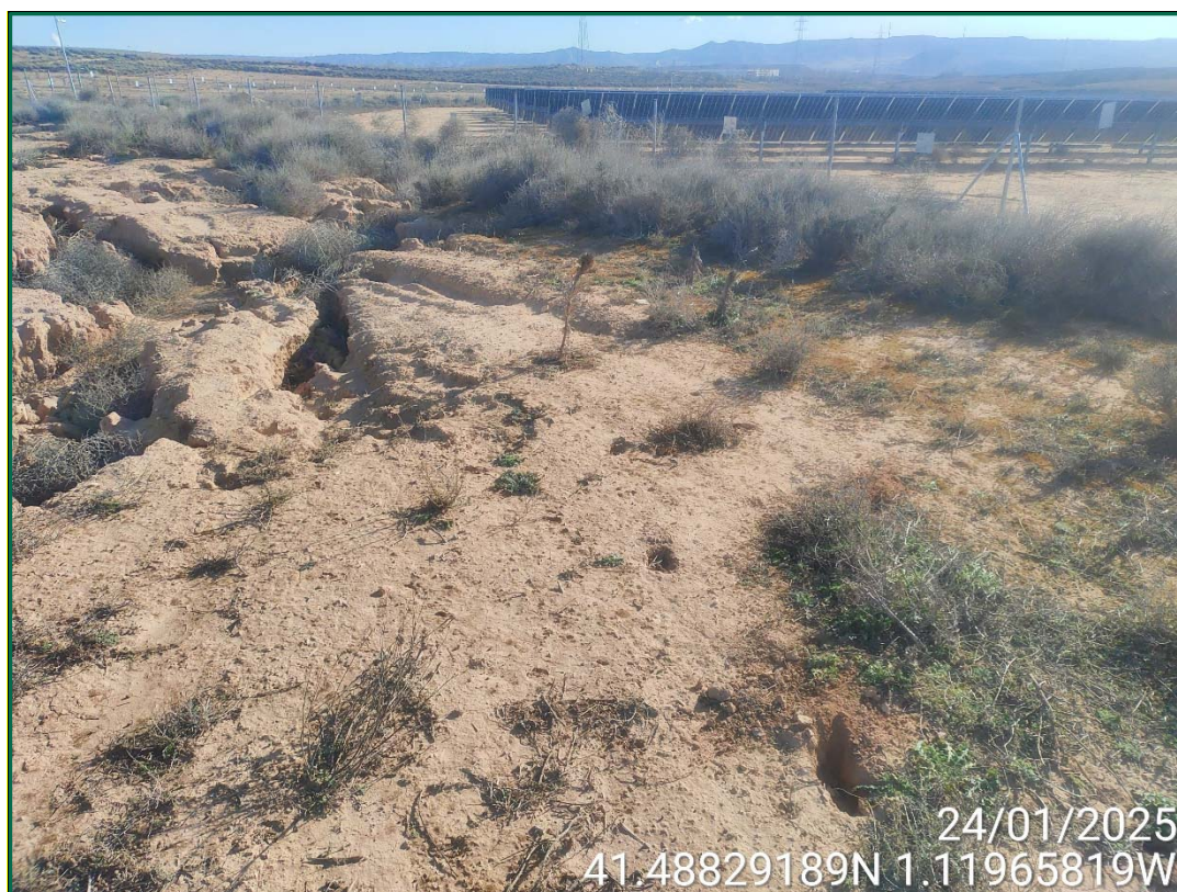
Fotografía 3. Erosión junto al vallado.
