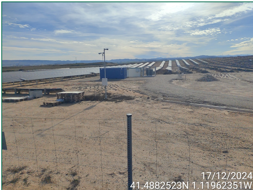
Fotografía 7. Zonas de acumulación de agua.
