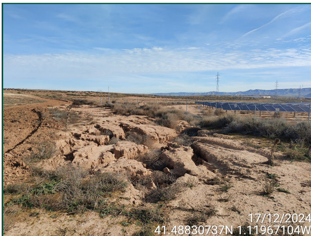
Fotografía 3. Erosión junto al vallado.
