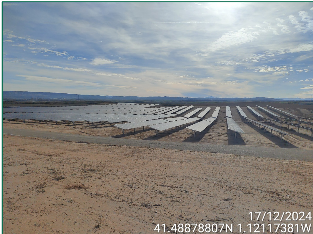
Fotografía 4. Erosión entre las placas fotovoltaicas.
