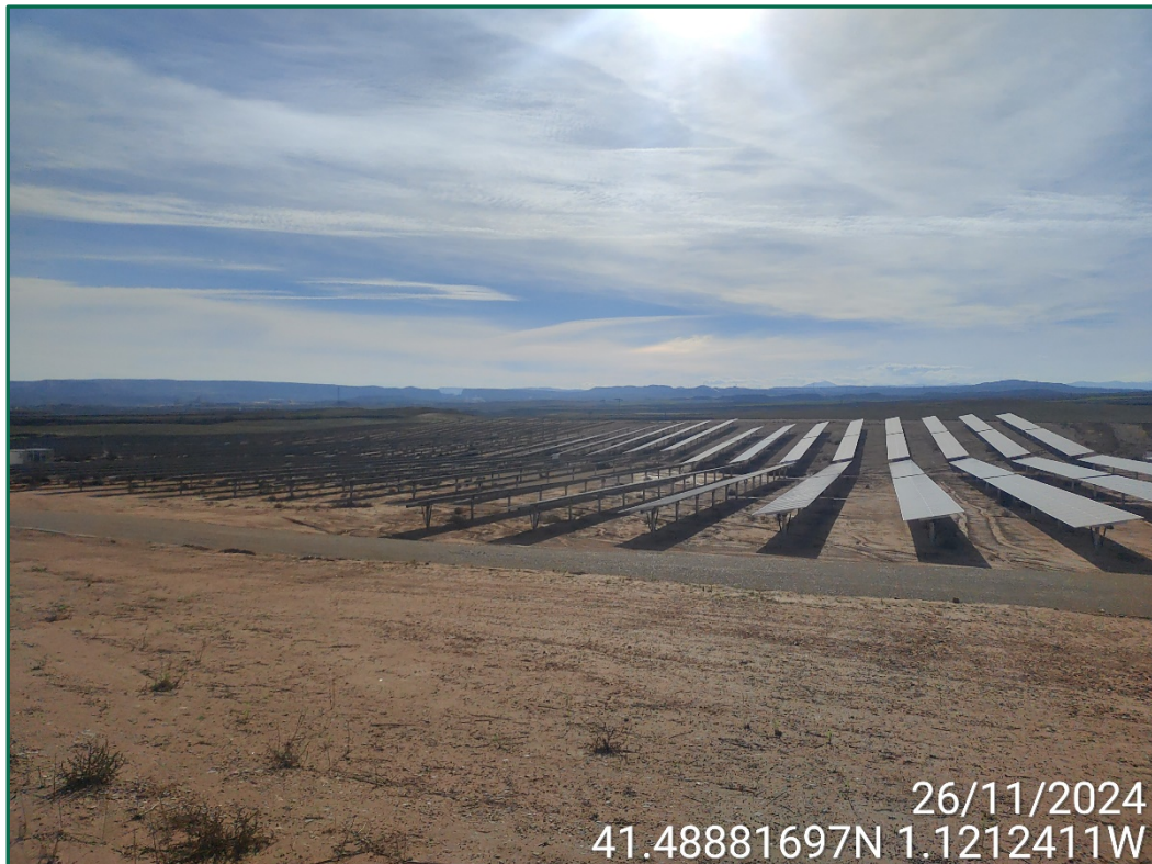
Fotografía 4. Erosión entre las placas fotovoltaicas.
