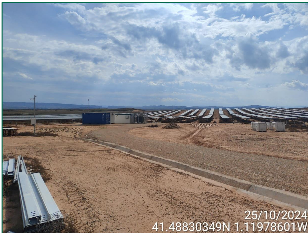
Fotografía 7. Zonas de acumulación de agua.
