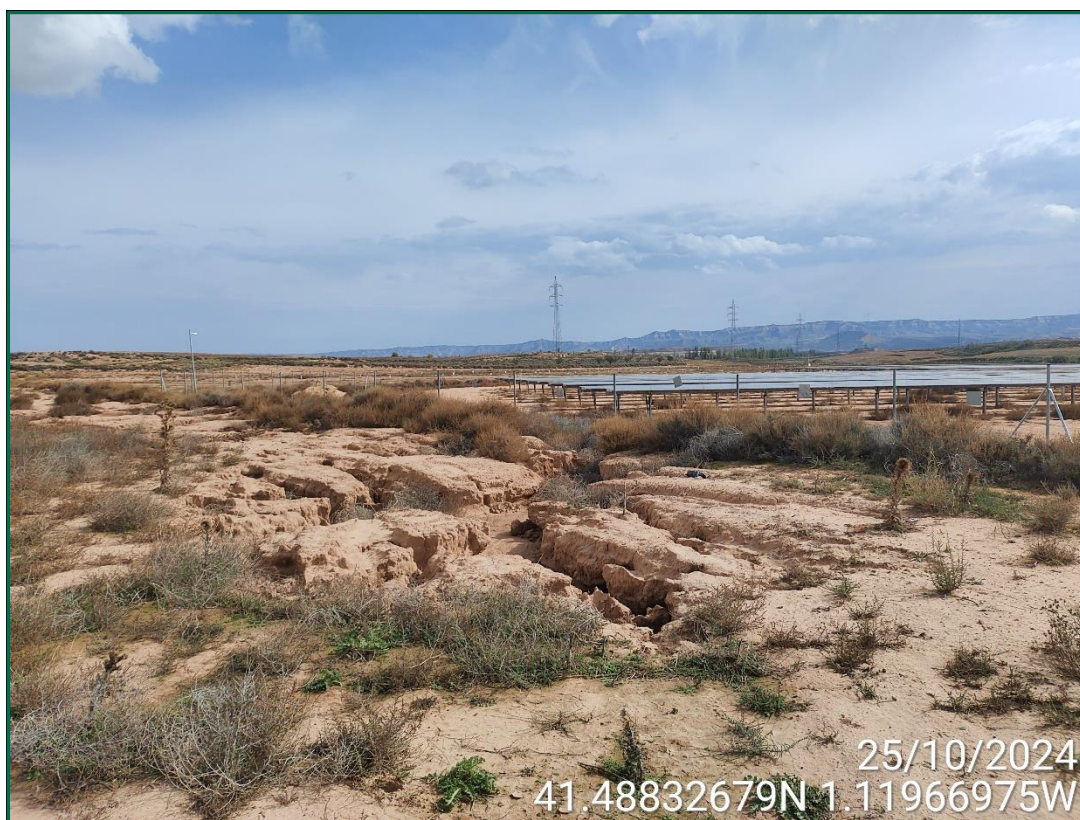
Fotografía 3. Erosión junto al vallado.
