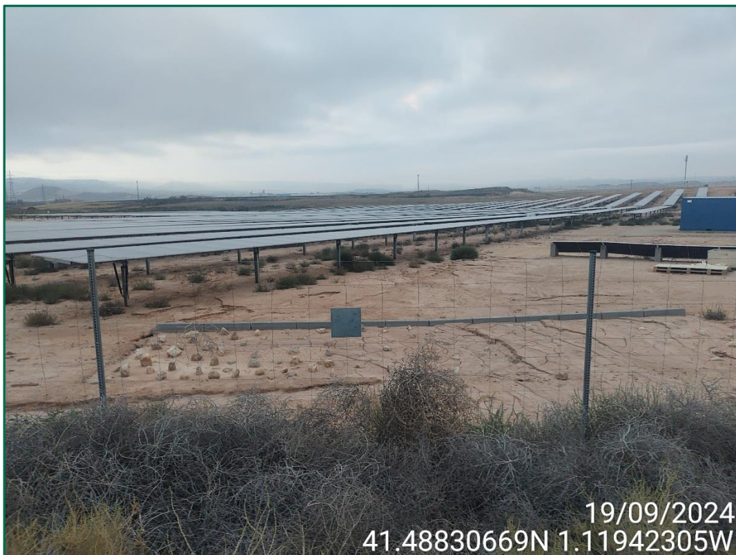
Fotografía 10. Zonas de acumulación de agua.
