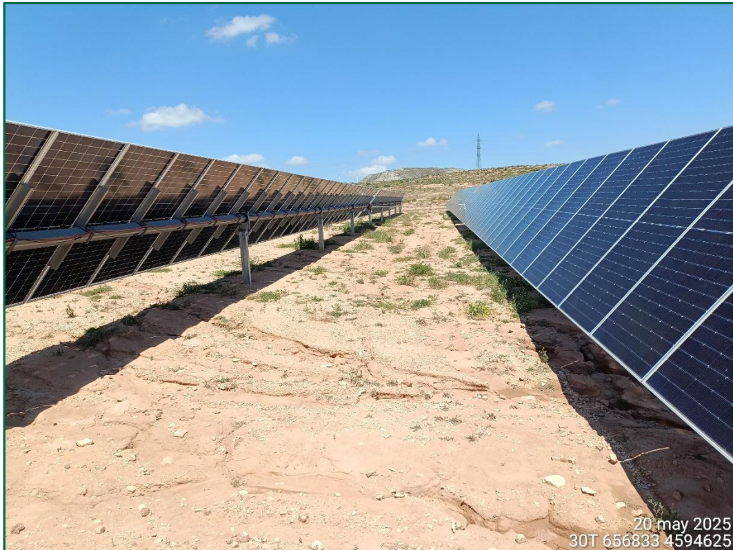
Fotografía 2. Erosión entre plaas solares.
