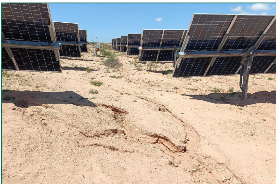
Fotografía 1. Erosión en el interior.
