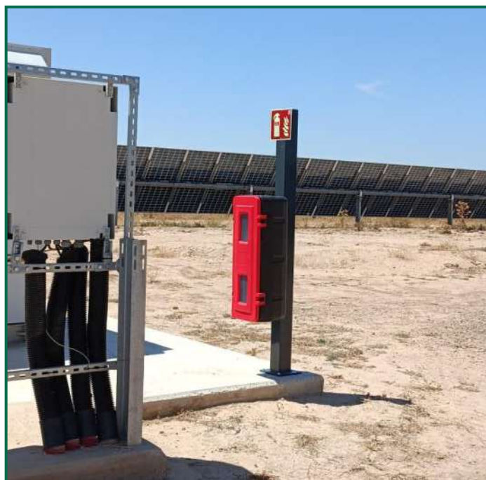
Fotografía 57. Extintor junto a centro de transformación.
