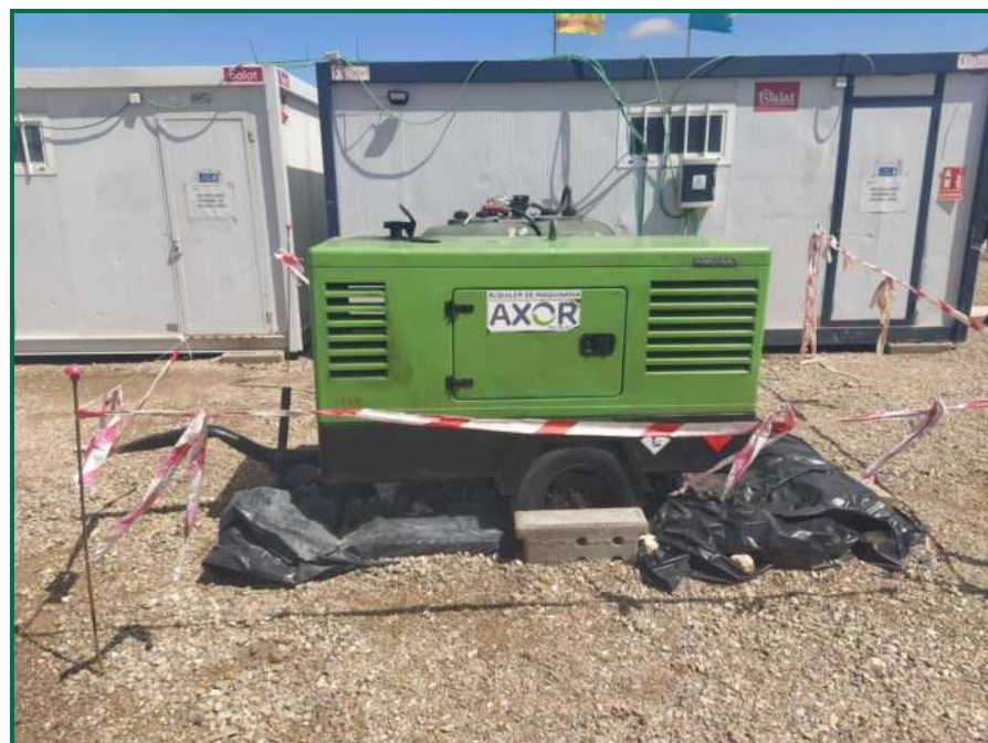
Fotografía 38. Grupo electrógeno de la zona de casetas de obra, ya retirado.
