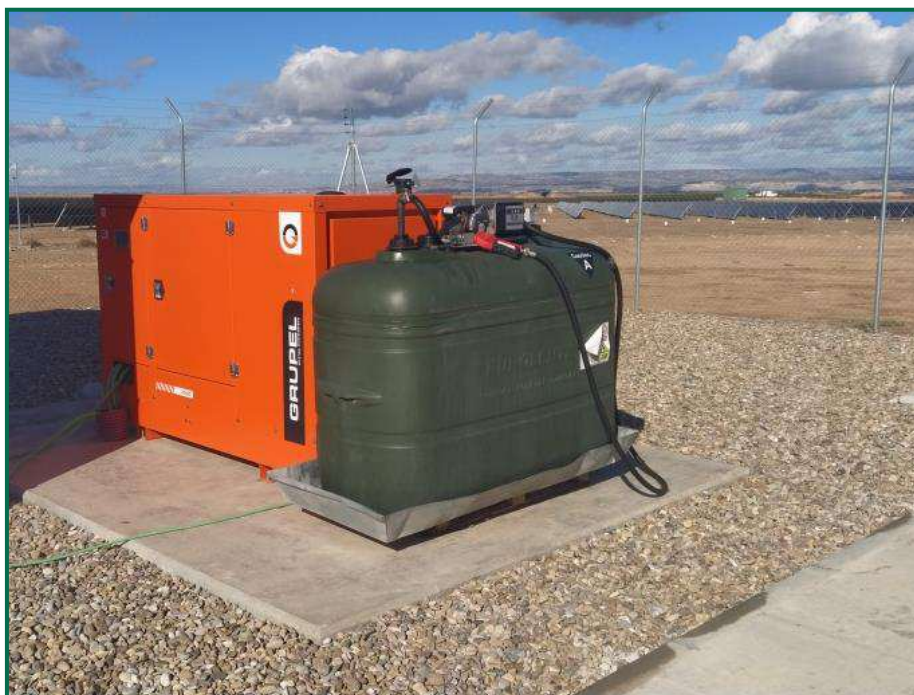
Fotografía 39. Grupo electrógeno en la SET.
