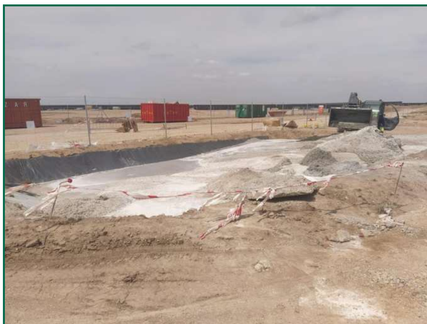
Fotografía 34. Zona de lavado de hormigón llena.
