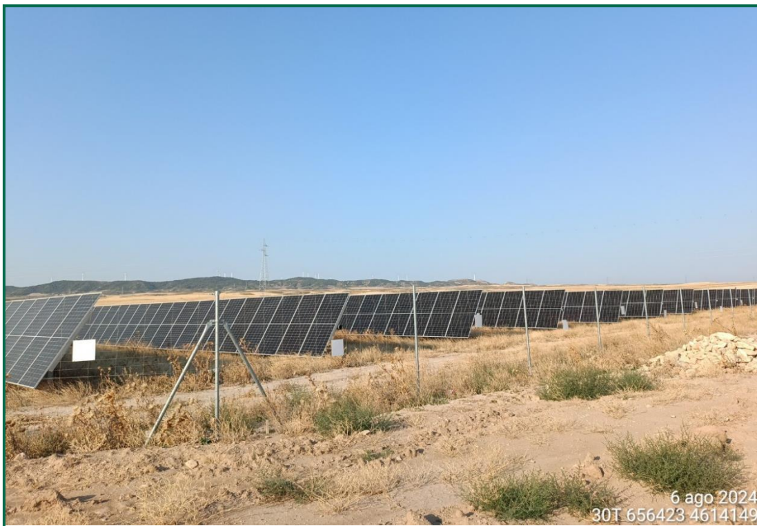
Fotografía 13. Vallado perimetral con placas anticollisión.
