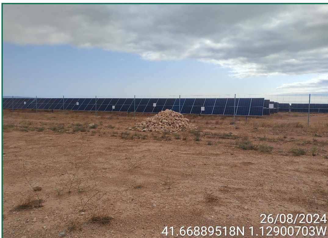
Fotografía 14. Vallado perimetral con placas anticollisión.
