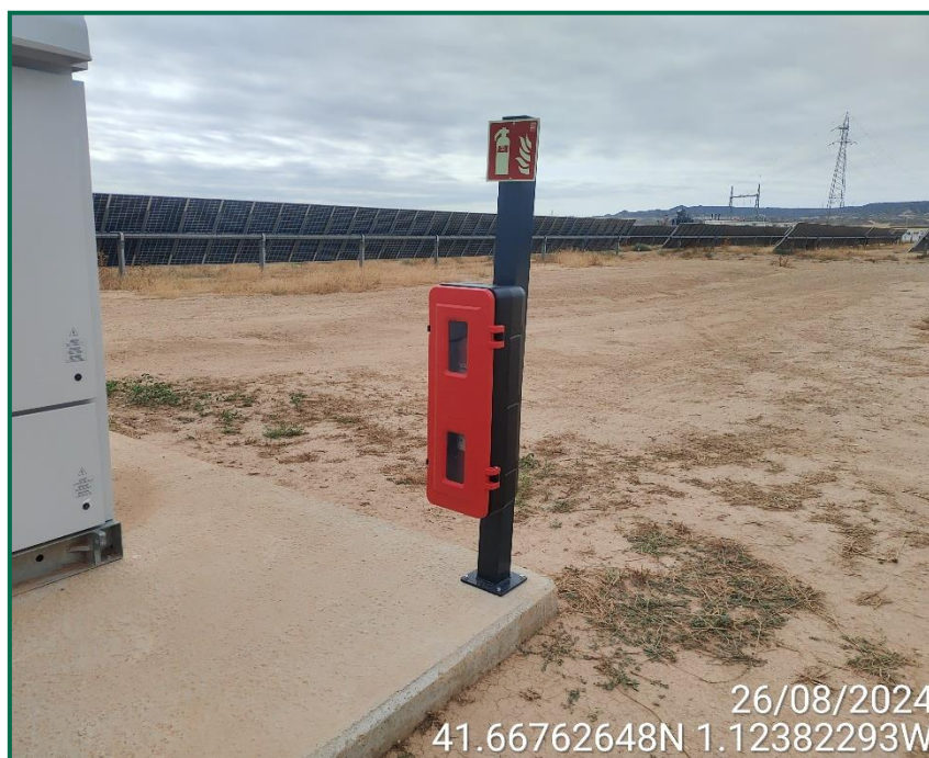
Fotografía 19. Extintor junto a inversor.
