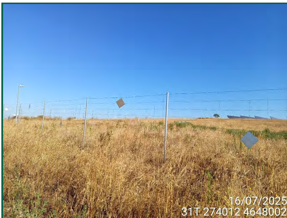
Fotografía 18. Placas anticolidión y vallado perimetral.
