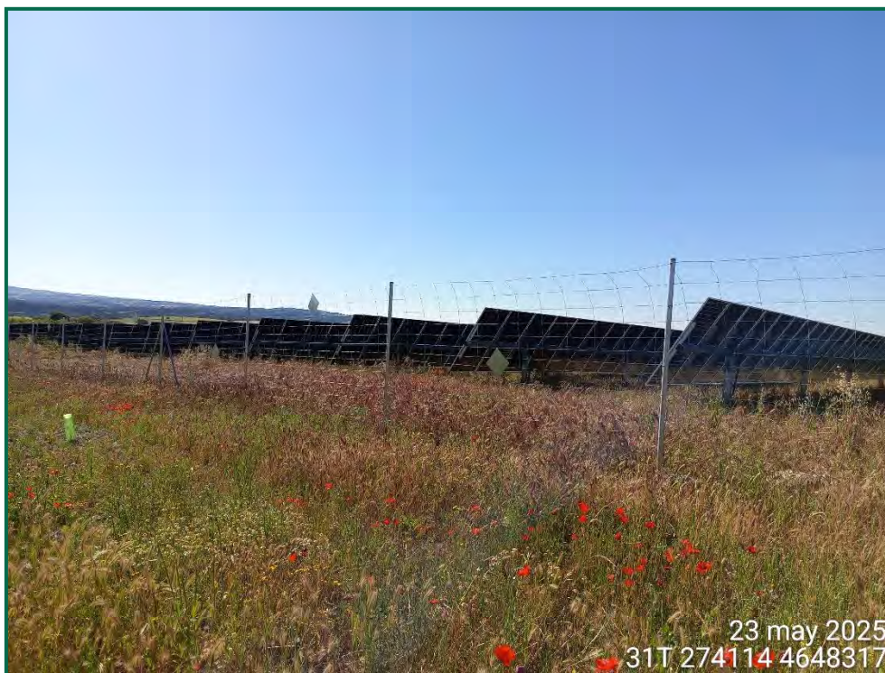
Fotografía 20. Placas anticolidión y vallado perimetral.
